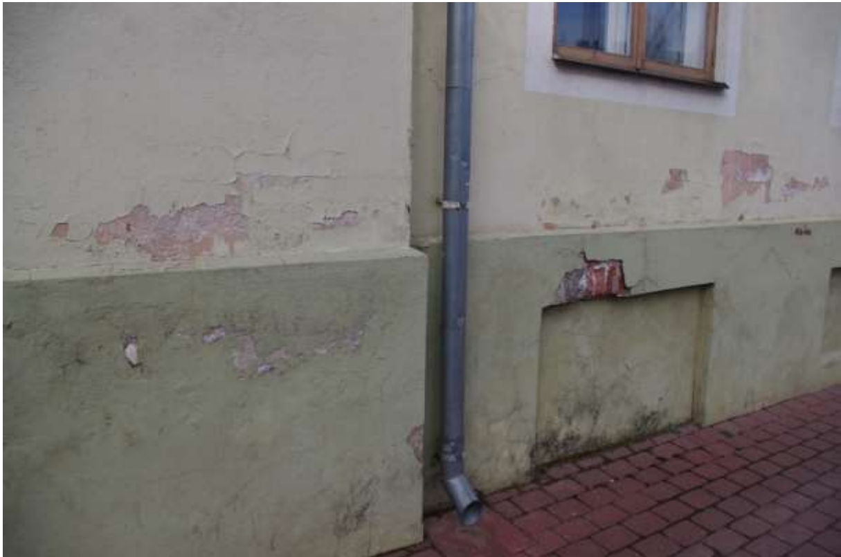
Pilt 1: Sokli tänavapoolne külg. Pragunenud ja murenenud krohv. Kooruv värv.
