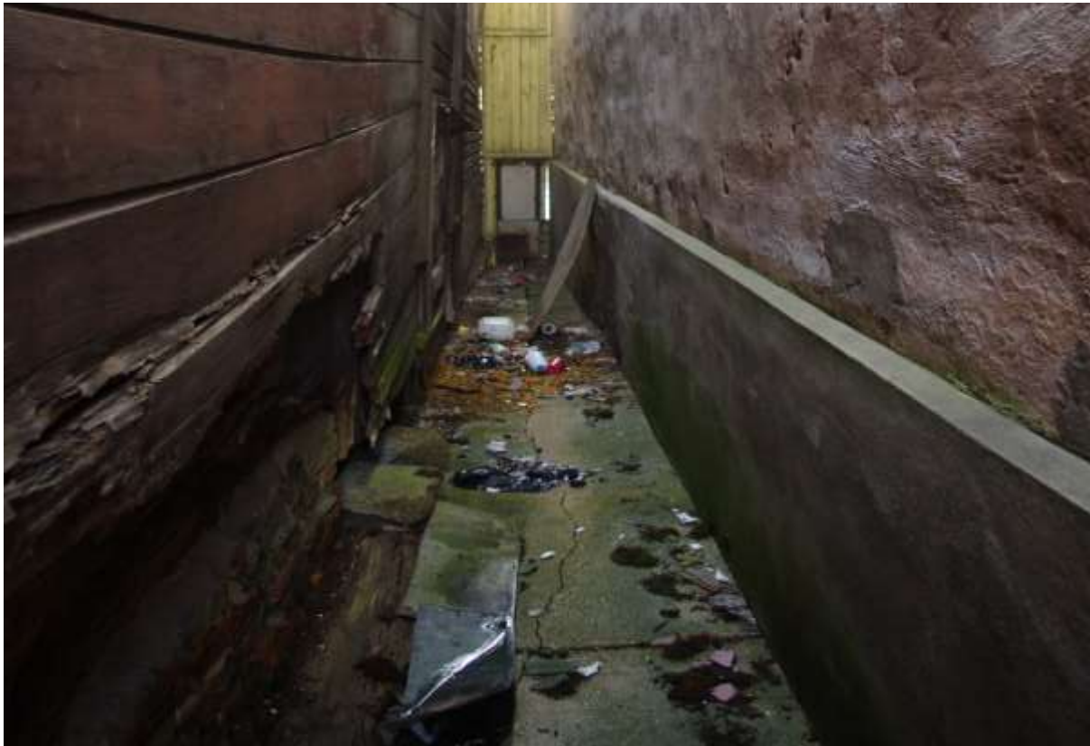
Pilt 8: Külgnemine kõrvalmajaga. Betoonpandust kahe maja vahel läbib üks pikk mõra, mis laseb kogu vee läbi. Hoone küljel on nähe vetikaid. Eelnevad parandused.
