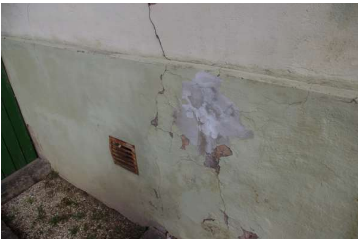
Pilt 4: Sokli parklapoolne külg suunaga hoovi poole. Pragunenud ja murenenud krohv. Vana parandus. Suur pragu jookseb mööda seinä üles. Roostes ventilatsiooniava.
