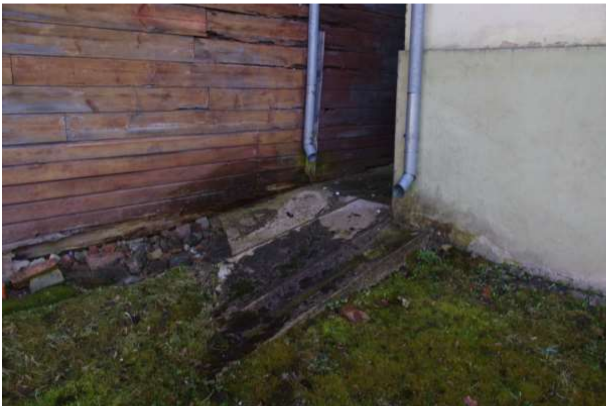
Pilt 7: Hoovipoolne nurk teise maja vastas. Betoonpandus on mõranenud ja laseb vett läbi. Mõlemal hoonel on näha pritsmeveest tulenevaid kahjustusi seinal.
