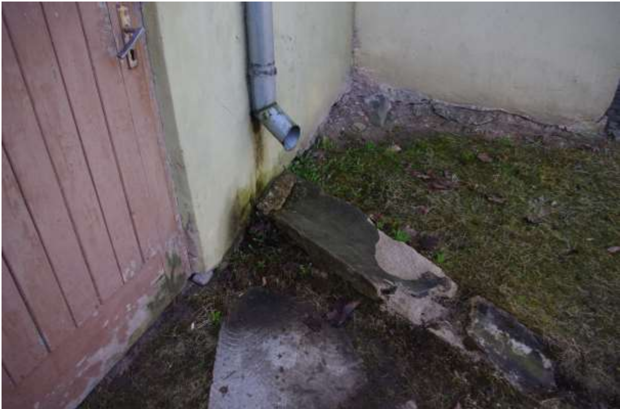
Pilt 6: Hoovipoolne külg. Sissekäik harjaruumi. Lagunenud betoonist vihmavee suunaja. Vetikad veerenni juures. Hoone välispind on krohvitud ja värvitud kuni maapinnani.
