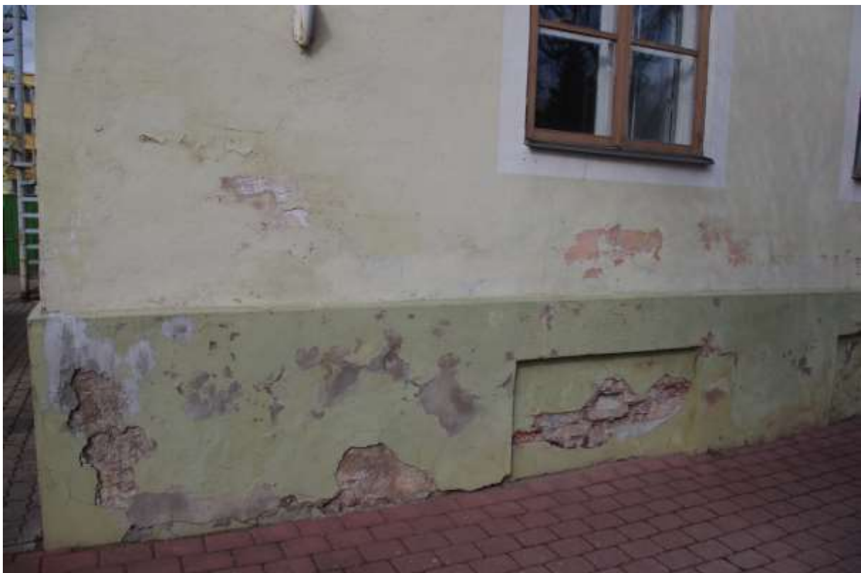
Pilt 2: Sokli tänavapoolne külg. Pragunenud, murenenud ja lahtine krohv. Kooruv värv. Vanad parandused. Mõranenud ja lagununud tellised.
