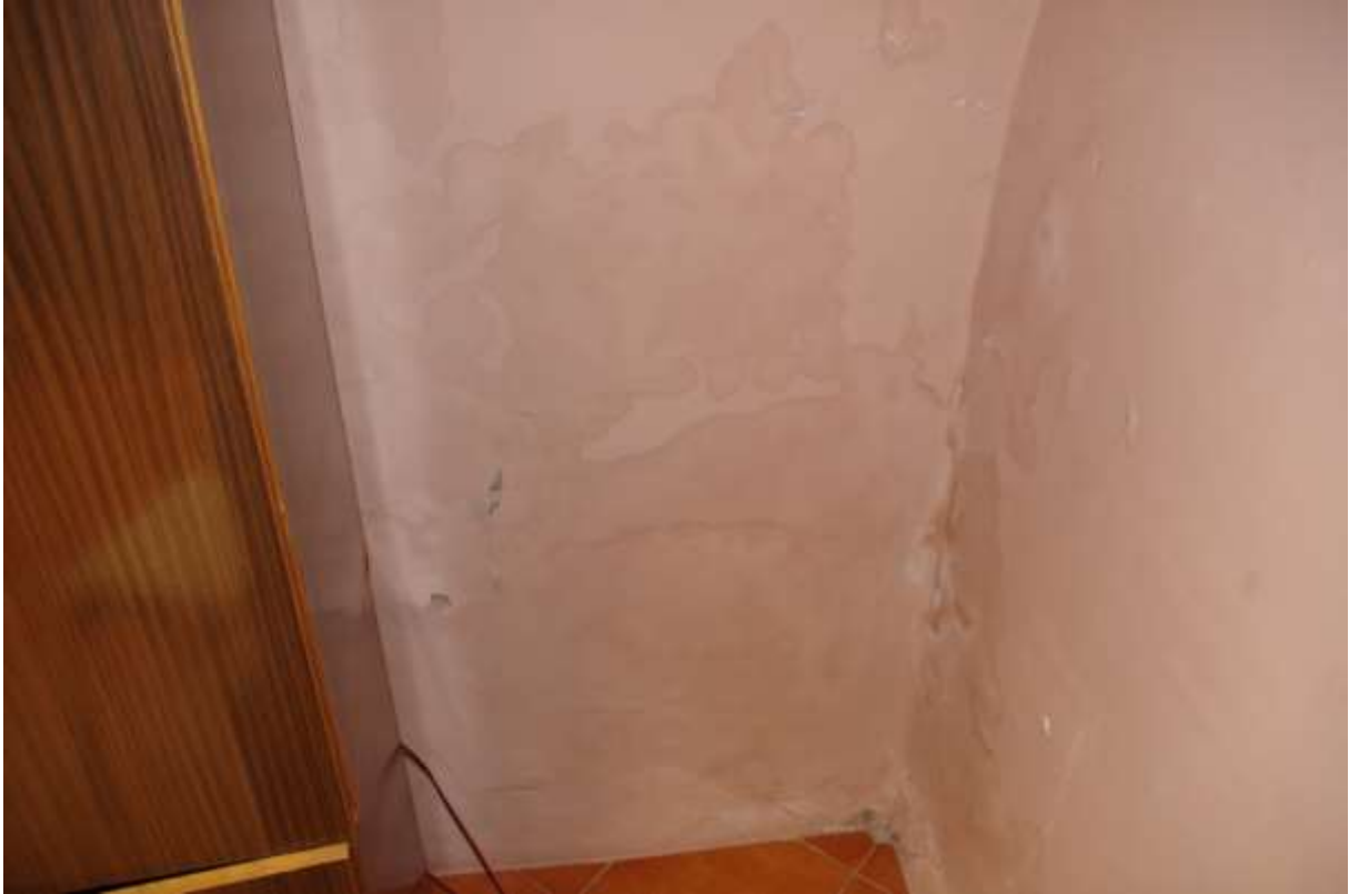
Pilt 15: Klassiruum 1 välisseina nurk. Kondensvee kahjustused.
