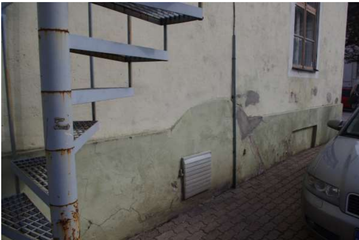
Pilt 3: Sokli parklapoolne külg suunaga täna poole. Pragunenud ja murenenud krohv. Kooruv värv. Vanad parandused nähtaval. Välisõhu sissetõmbeava kütteelementi.
