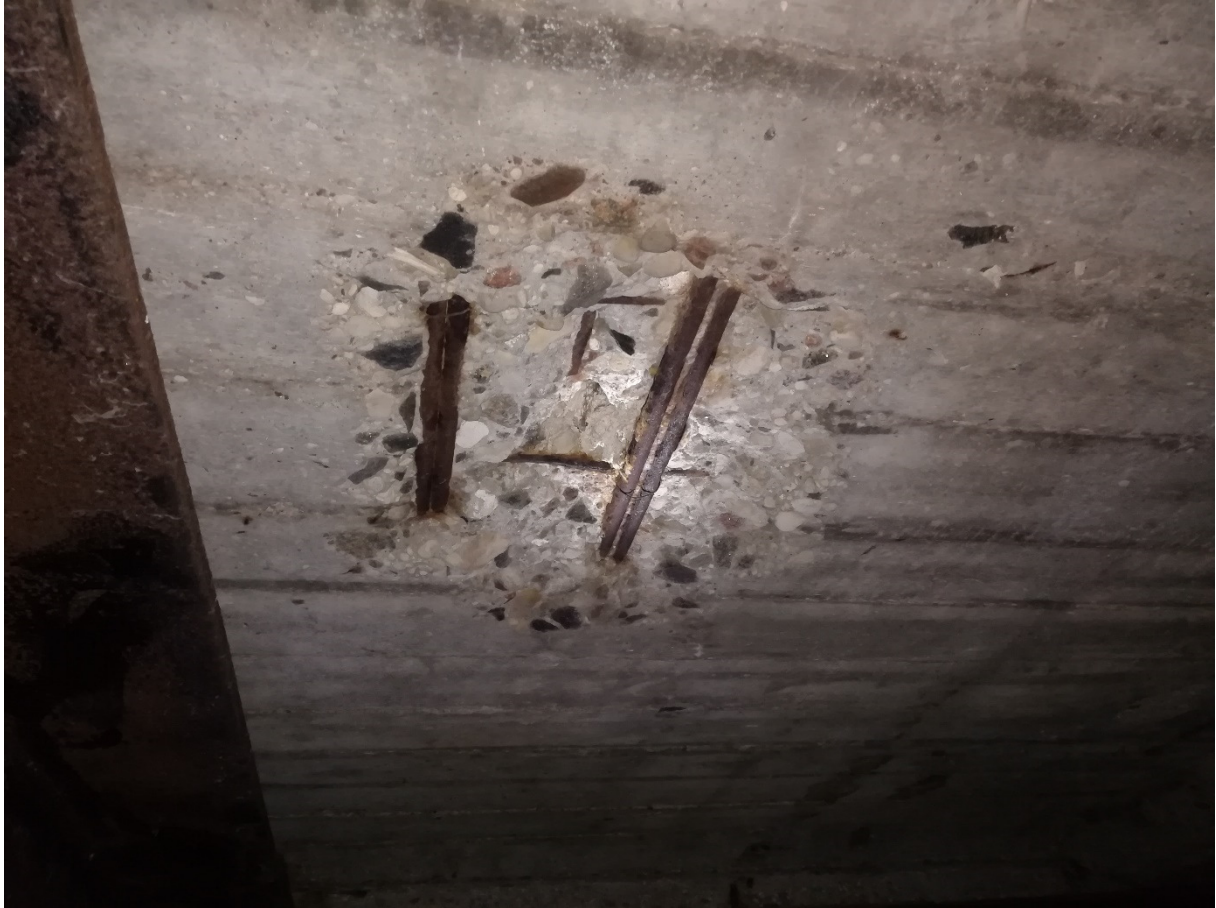
Foto 4.9 Tekiplaadil betoonist kaitsekiht eraldunud, armatuur korrudeerub
