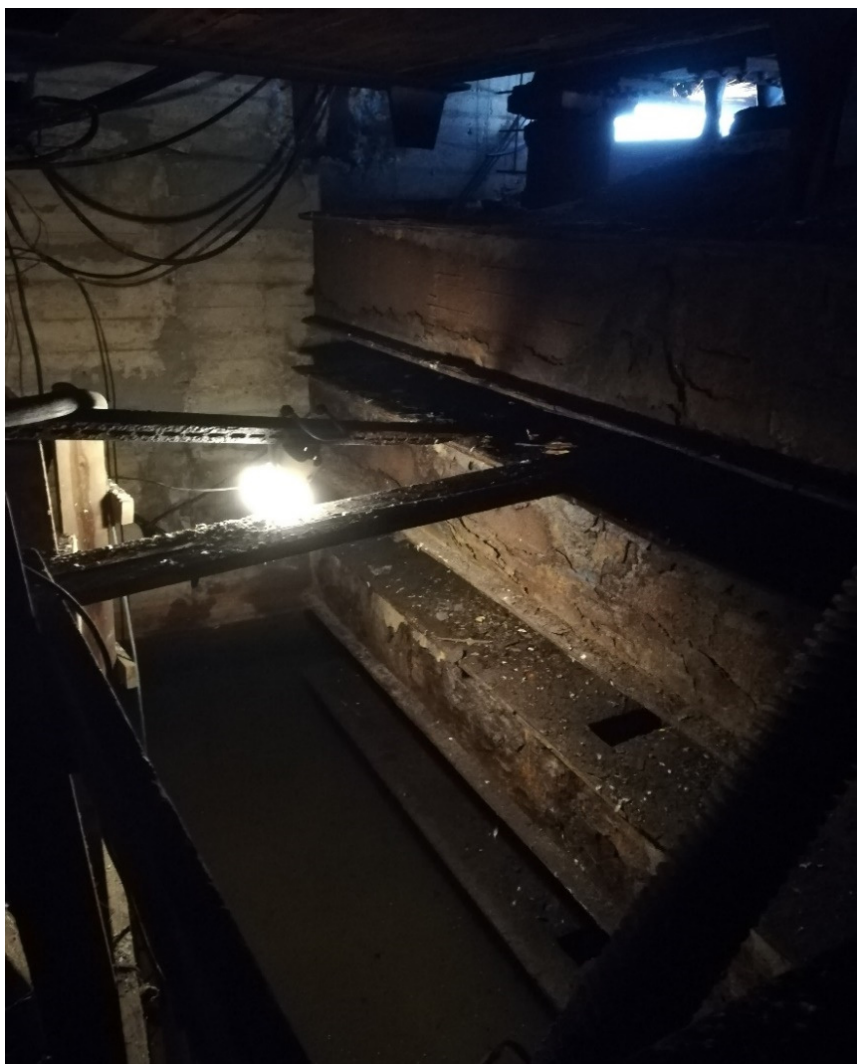
Foto 4.18 Klapisammastesse on valgunud vesi (1,5m – 2m), vasturaskused osaliselt vee sees
