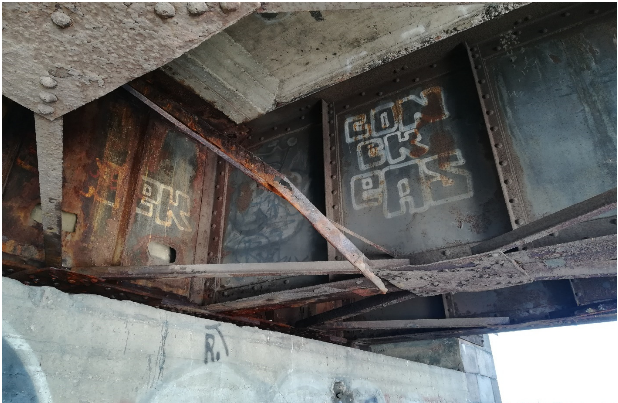
Foto 4.11 Peatalade korrosioon ulatuslikum vuukide juures
