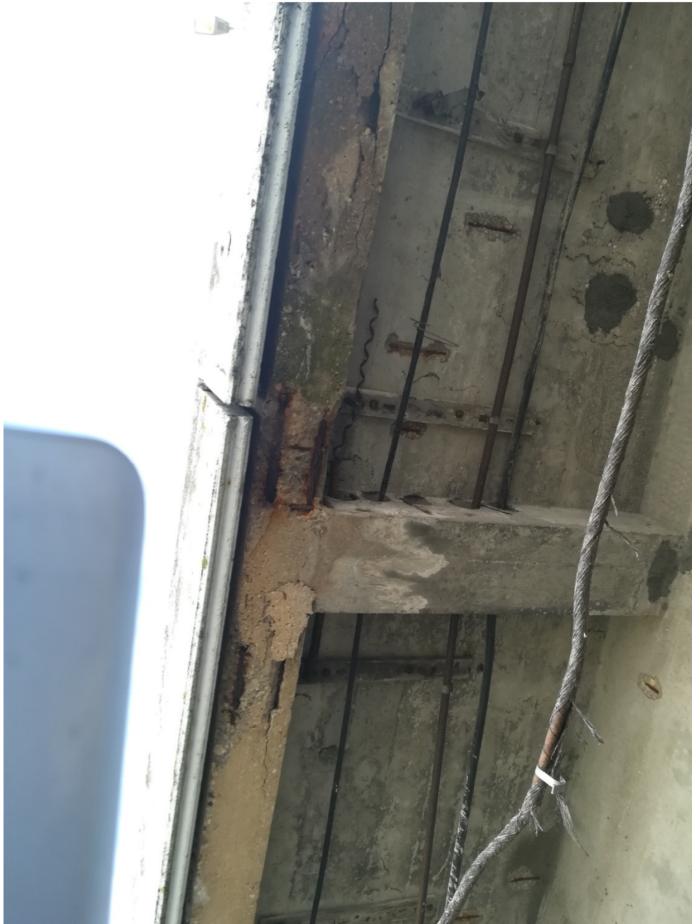
Foto 4.16 Kõnnitee konsoolisel osal kaitsekiht eemaldunud, paljandunud armatuur korrudeerub
