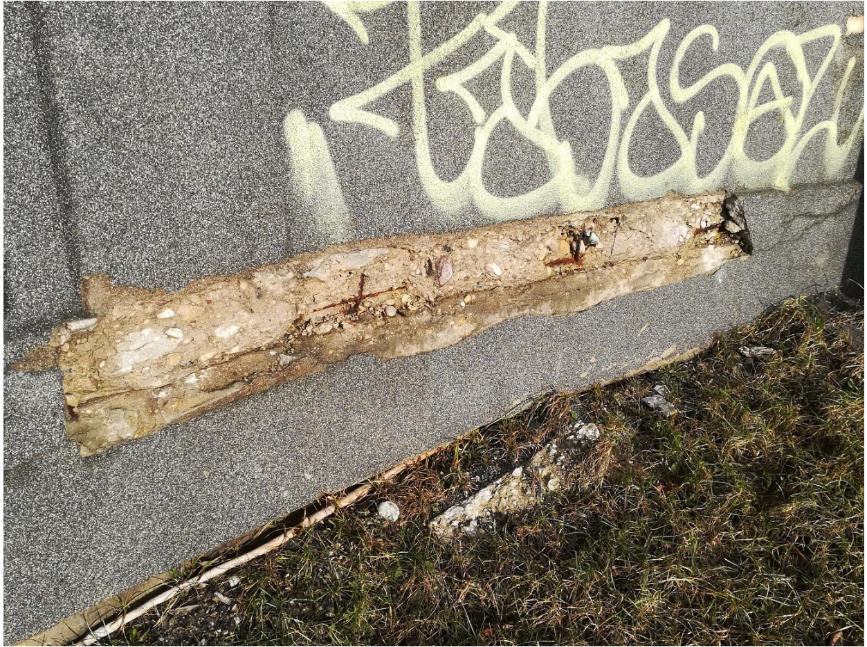
Foto 4.21 Silla tugiseinal terrasiitkrohv koos kaitsekihiga eraldunud, palajandub korrudeeruv armatuur
