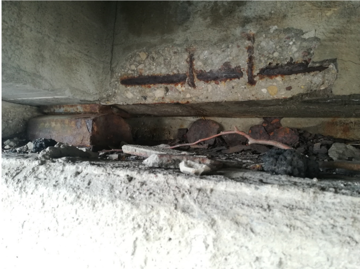
Foto 14 Betoon ribiplaadil kaitsekiht eemaldunud, paljandunud korrudeeruv armatuur
