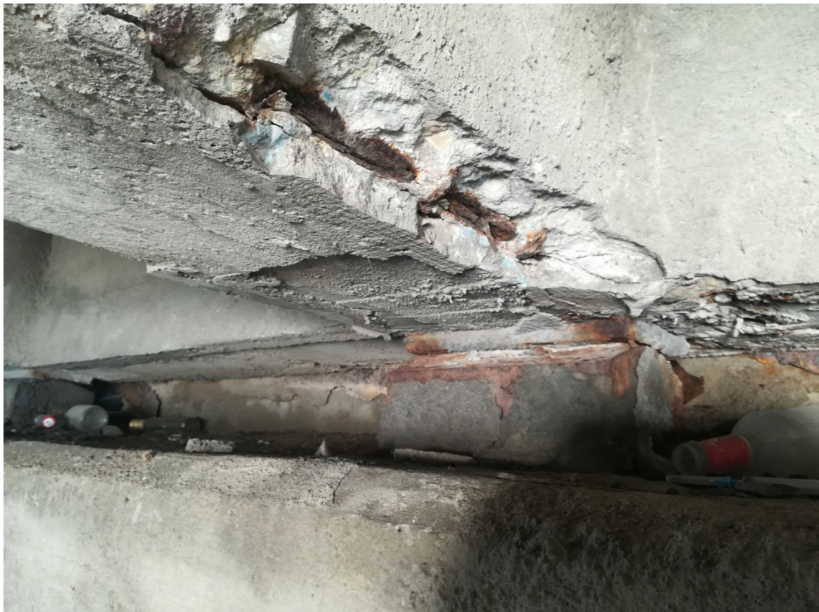
Foto 15 Betoon ribiplaadil kaitsekiht eemaldunud, paljandunud armatuur korrudeerub
