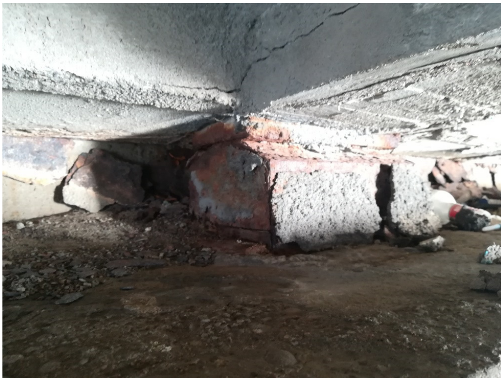
Foto 4.20 Ribiplaati toetavatel tugisosadel korrosioonikahjustused, mis on viinud sfäärilise tugiosa kihistumiseni ja lahti koorumiseni
