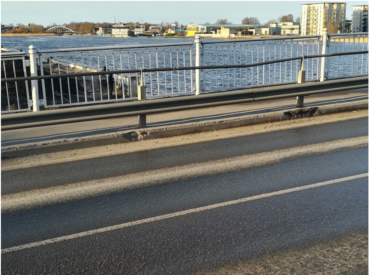
Foto 4.8 Sõidutee valatud äärekest on piirdepostide juures betoon eemaldunud ning paljandub korrudeeruv armatuur. Ilmselt avari tagajärg
