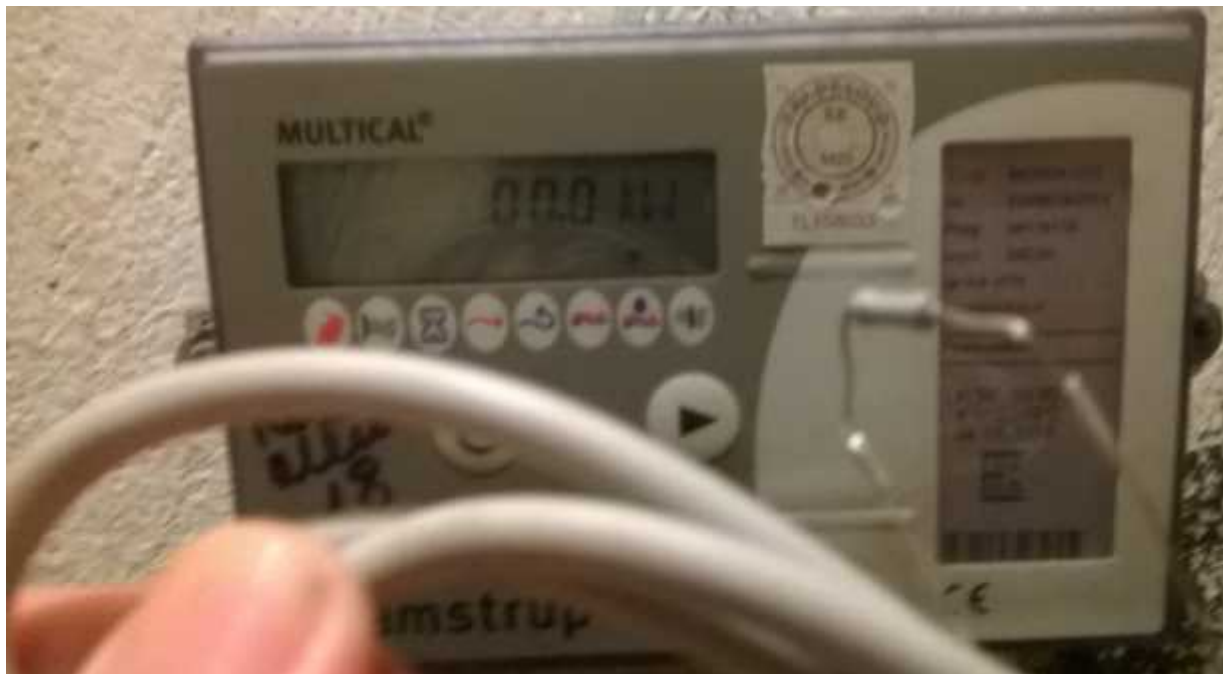
Joonis 4.12. Arvesti näit on 0 toitekaablisse ühendatud takistiga
