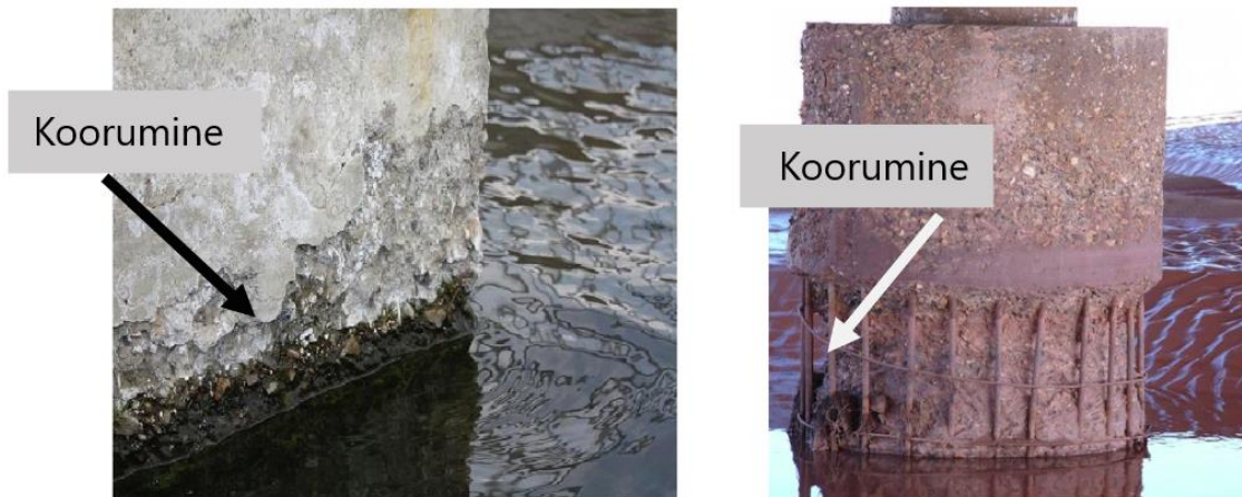
Joonis 1.1 Betooni koorumine külmakahjustuse tõttu [24]
