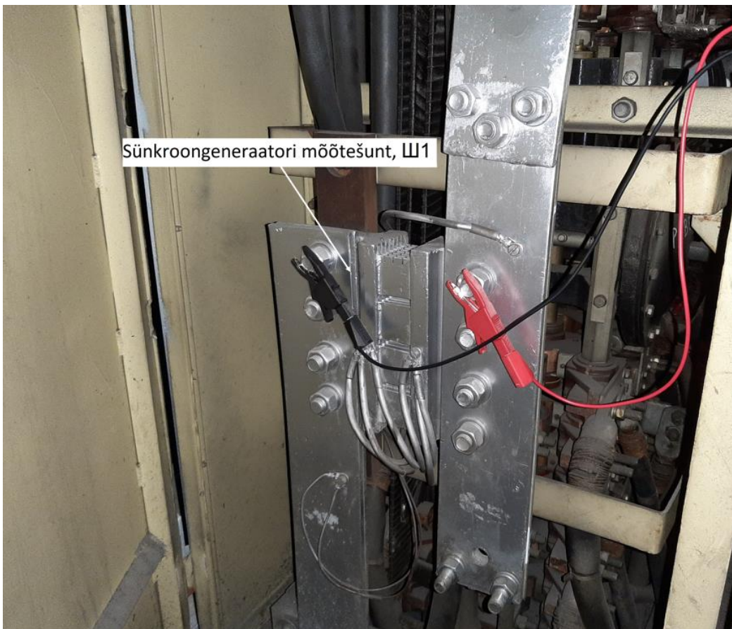
Joonis 4.3. TEP70-0237 sünkroongeneraatori mõõtesundi ühendamiskoht
