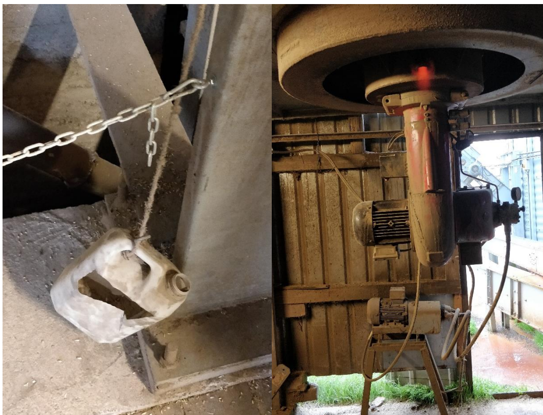
Foto 1. Kuivatis tuvastatud olulised ohuallikad. Vasakpoolsel fotol on remonttöödel kasutatav käepärastest vahenditest ise valmistatud „lift“. Parempoolsel fotol on näha kuivati põletist väljuv leek, mis jääb vahetult sissepääsu juurde käigurajale. (E. Zirk, 2018)
