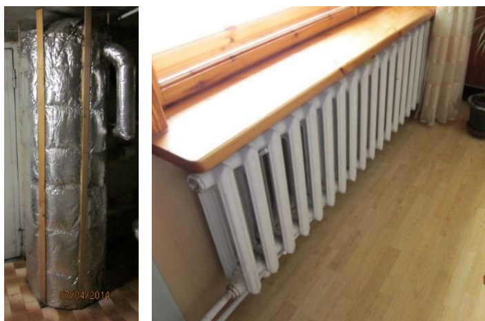
Joonis 5.9. Sooja tarbevee boiler ja malmradiaatorid
