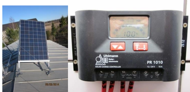
Joonis 6.1. Objekti elektripaneel (vasakul pildil) ja Uhlmann Solar Charge kontrolleri PR1010 (paremal pildil)
