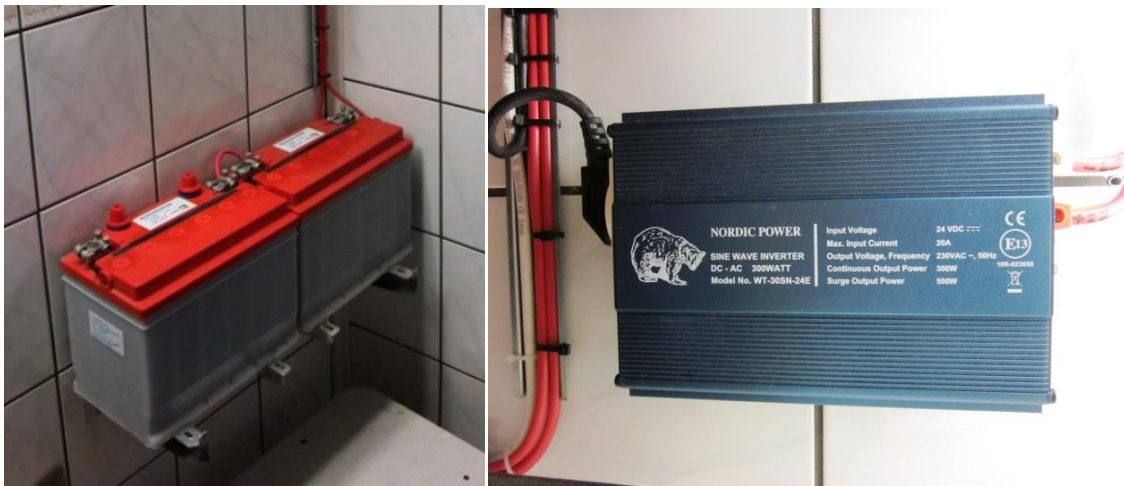
Joonis 6.2. Akupank 24 V ja Nordik Power inverter
