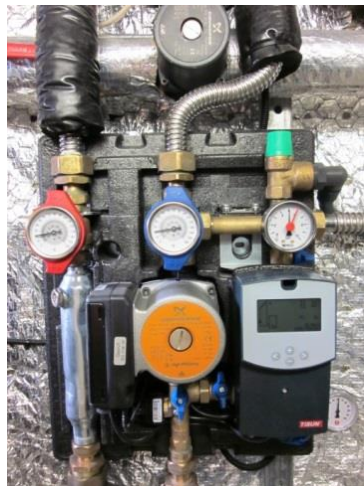
Joonis 5.5. Päikesekollektorite pump ja selle kontrolleri
