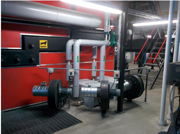
Sele 9.3. Primaar-, sekundaar- ja tertsiaarõhu ventilaatorid hakkepuidu katla kõrval Põlva katlamajas.[20]
