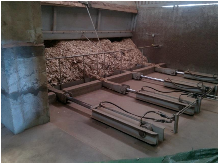
Sele 9.2. Esiplaanil hakkepuidu lao hüdrutõukurid Reola katlamajas, Tartumaal. [20]
