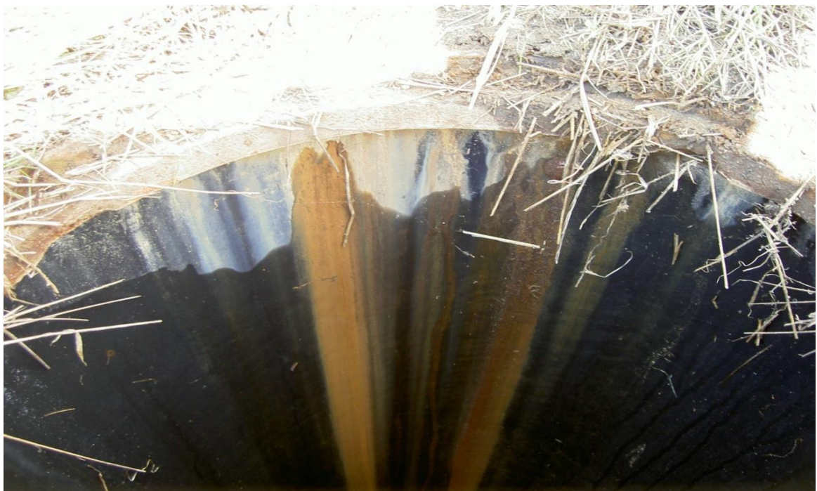
Joonis 4. Võõrvee sissetung reoveekanaliseerimise kaevu krae ja –teleskooptoru vahelt. Kaevu krae sissevoolava vee kohalt terve. Kaev L-J8.
