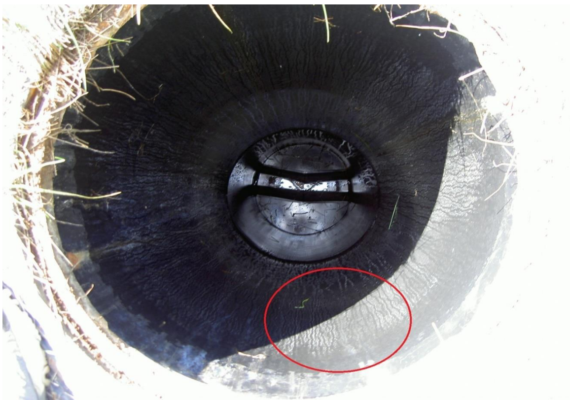
Joonis 6. Vee voolamise jäljed kaevu teleskoopitorul. Kaev L-J25.
