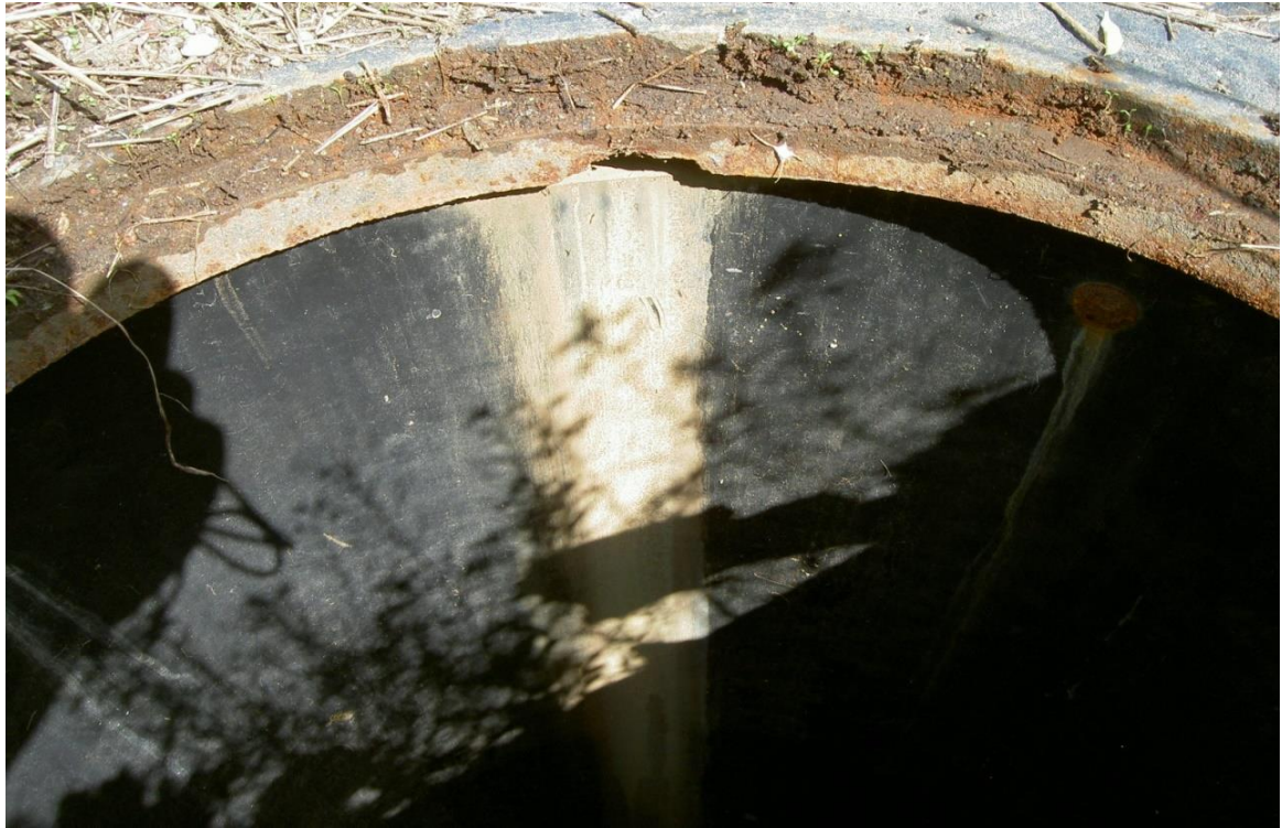
Joonis 3. Võõrvee sissetung reoveekanaliseerimise kaevu krae ja –teleskooptoru vahelt. Katkine kaevu krae. Kaev L-J7.
