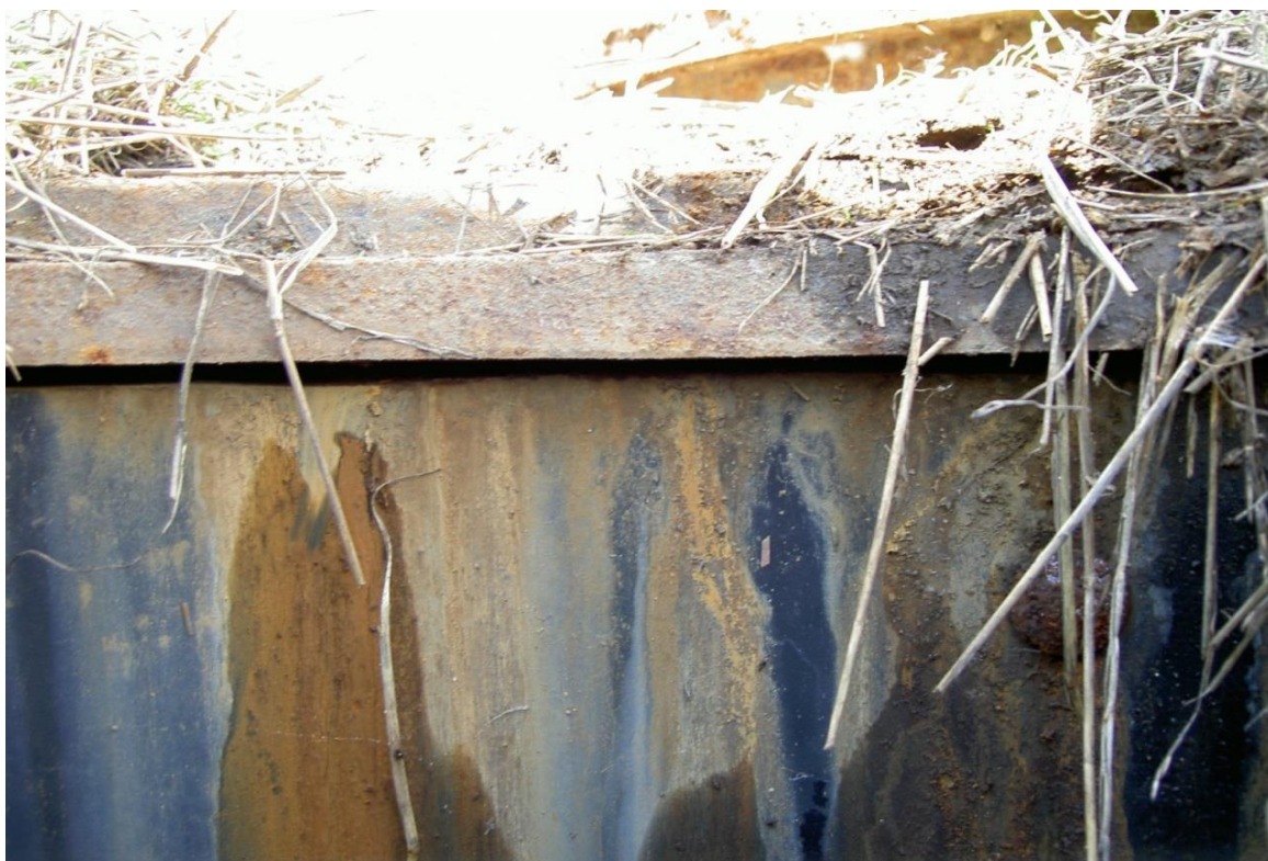
Joonis 5. Võõrvee sissetung reoveekanaliseerimise kaevu krae ja –teleskoopitoru vahelt. Kaevu krae sissevoolava vee kohalt terve. Kaev L-J8.
