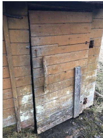
Joonis 8 Viltu vajunud ning voodrilaudadega kaetud välisuks
