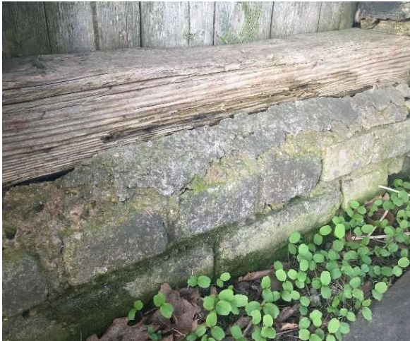
Joonis 2 Niiskuskahjustusega sokkel
