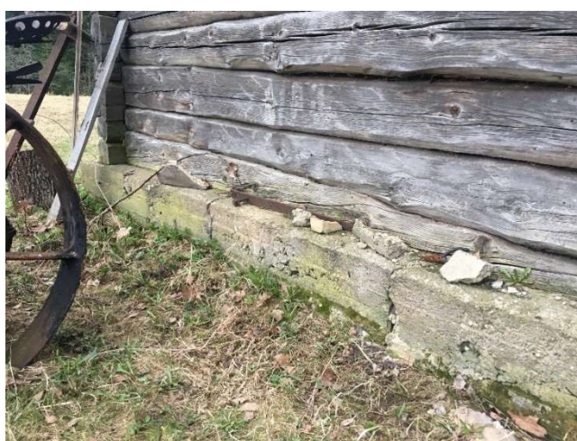
Joonis 3.2 Ülevalatud, niiskuskahjustuste ja pragudega sokkel
