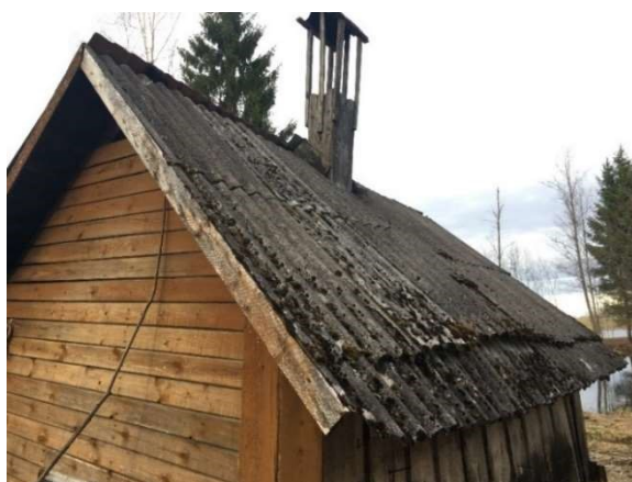
Joonis 3.9 Deformeerunud kandekonstruktsioonid ja katusekate
