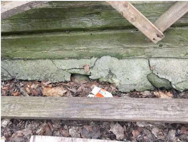
Joonis 2 Niiskuskahjustustega vundament ja alumised palgiread
