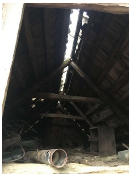
Joonis 3.6 Katuse kandekonstruktsioon ja avariiline katusekate
