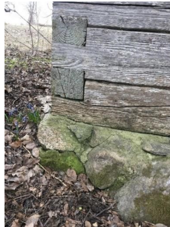
Joonis 3 Niiskuskahjustustega sokkel
