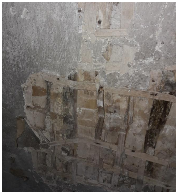
Joonis 2.15 Hoone lõunapoolse osa esialgsest hoonest säilinud krohvivõrgu ning krohviga kaetud palksein (autori foto, märts 2021)
