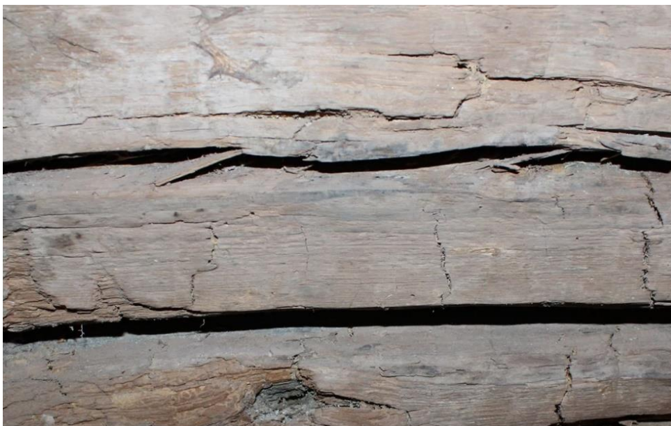
Joonis 2.39 Majavammi tõttu lagunenuid puit (autori foto, oktoober 2016)
