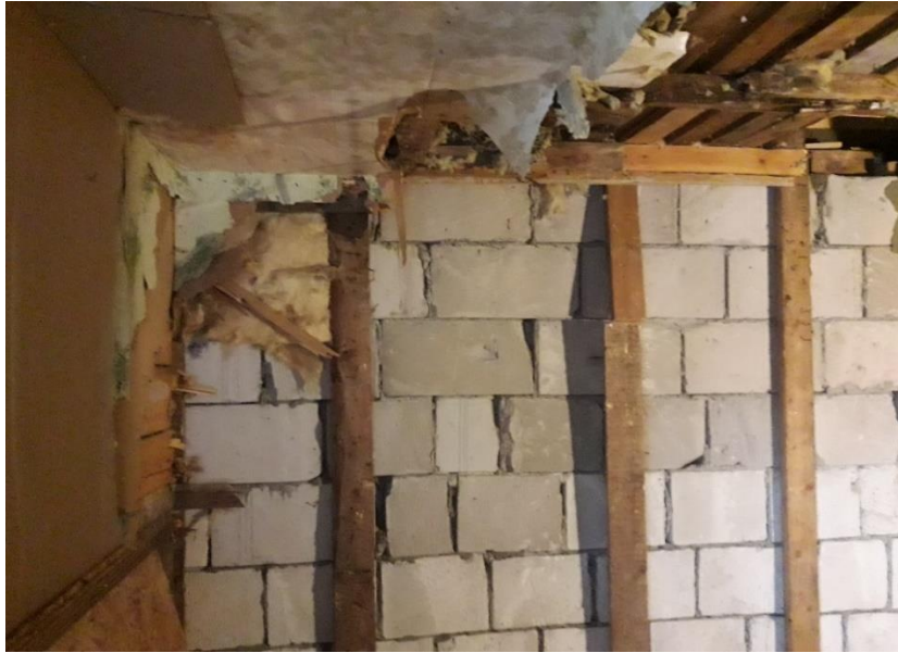
Joonis 2.14 Hoone põhjapoolse osa välissein seestpoolt (autori foto, märts 2021)
