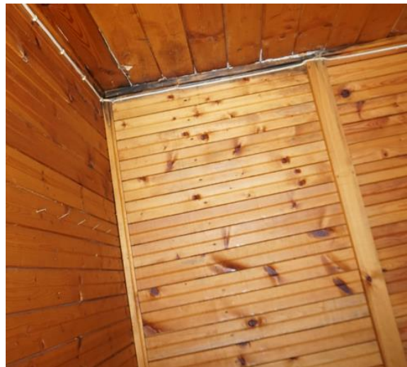
Joonis 3.47 Vaade niiskuskahjustustele (Foto: autor, märts 2022)
