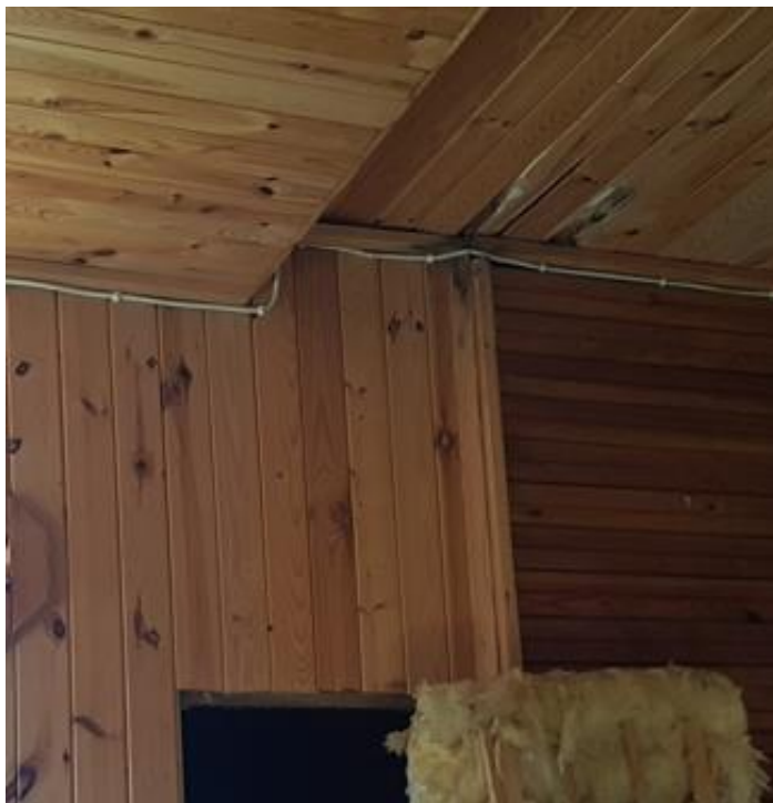
Joonis 3.54 Vaade niiskuskahjustustele (Foto: autor, märts 2022)
