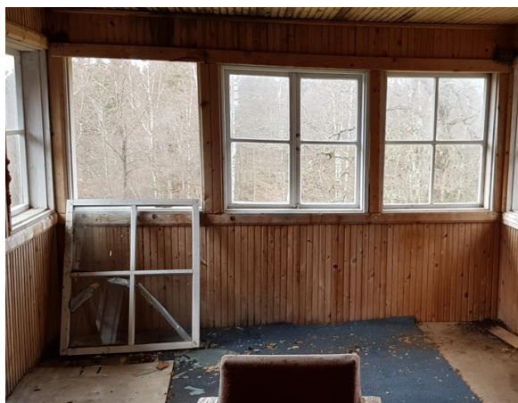
Joonis 3.62 Vaade teise korruse kinniehitatud rõdule, aken on terve raamiga eest tulnud (Foto: autor, märts 2022)
