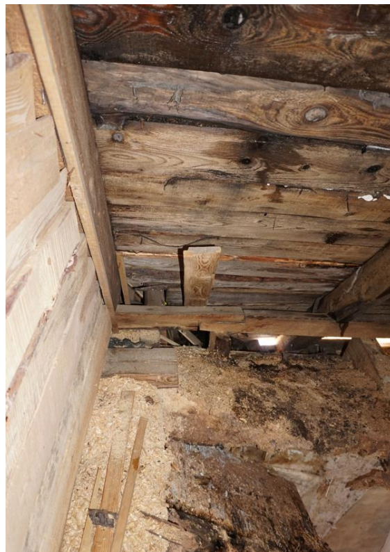
Joonis 3.68 Vaade niiskuskahjustustele (Foto: autor, märts 2022)
