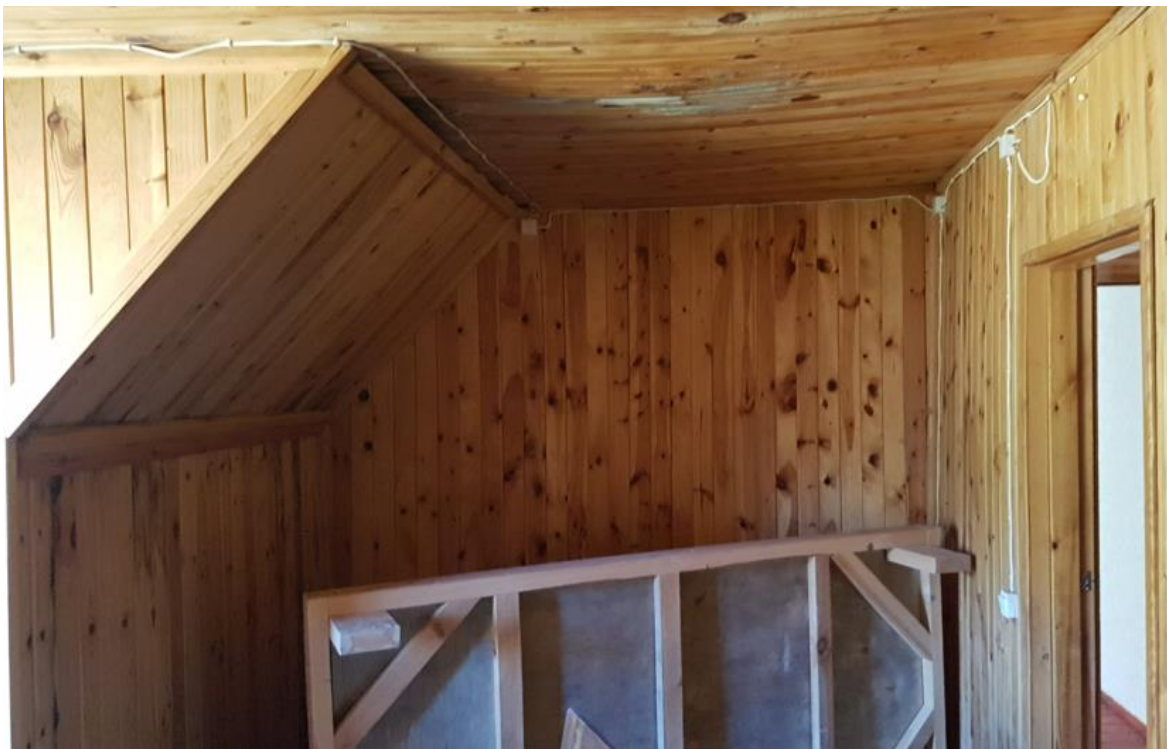
Joonis 3.61 Vaade niiskuskahjustustele (Foto: autor, märts 2022)
