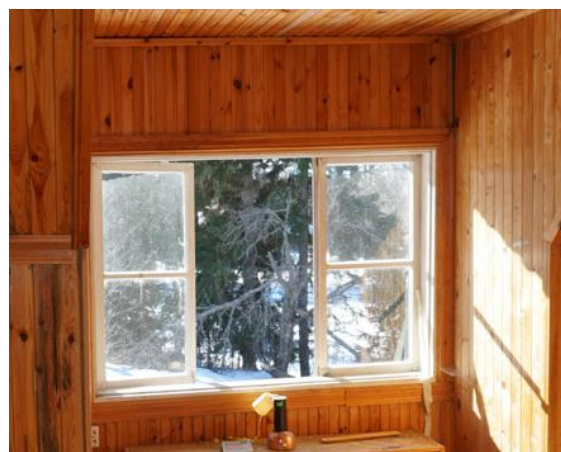
Joonis 3.17 Eest kukkunud keskmise raamiosaga aken (Foto: autor, veebruar 2022)
