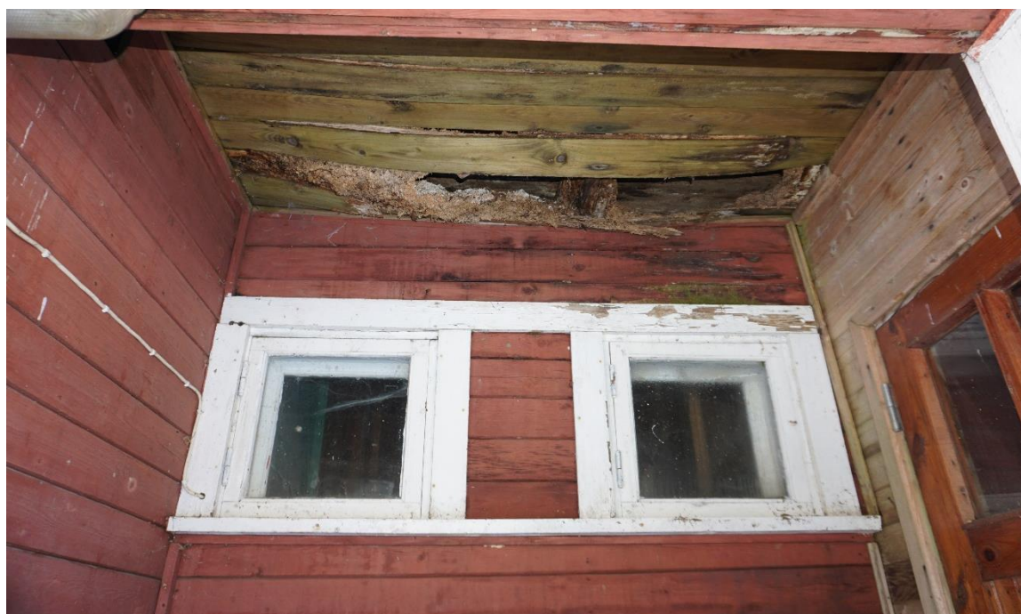
Joonis 3.72 Vaade kahjustunud katusele (Foto: autor, märts 2022)
