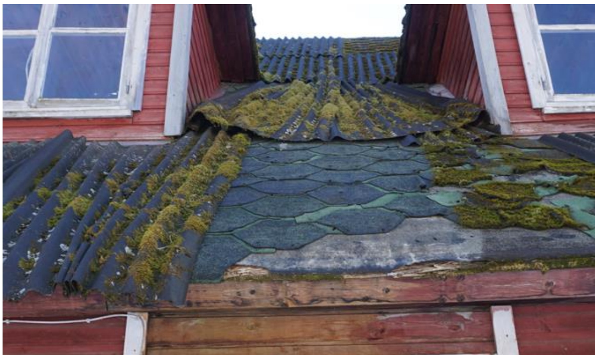
Joonis 3.7 Katuse erinevad kihid pealtpoolt: laineline ruberoid, kuusnurkne bitumeensindel, tõrvapapp, lisaks nähtaval kahjustunud räästalaud ning fassaadilaudis (Foto: autor, veebruar 2022)
