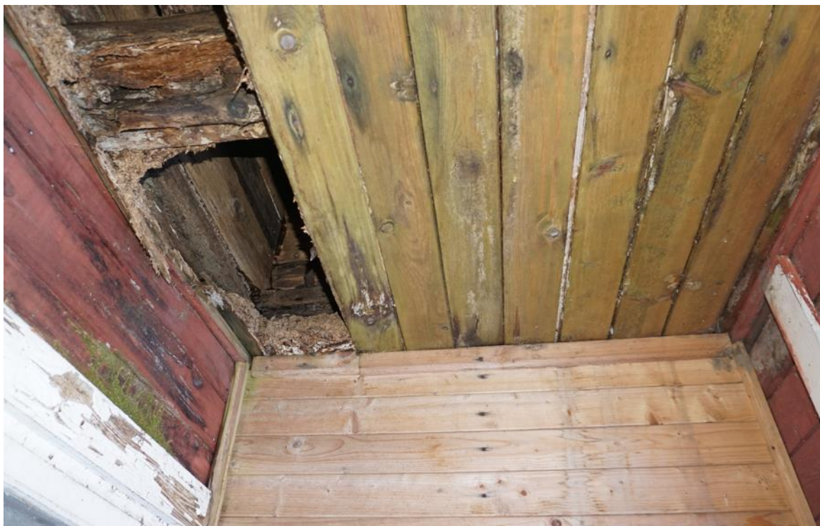
Joonis 3.71 Vaade kahjustunud vahelaetaladele ning laelaudisele (Foto: autor, märts 2022)
