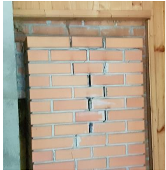
Joonis 3.24 Teise korruse savitellistest ahju läbiv pragu (Foto: autor, veebruar 2022)
