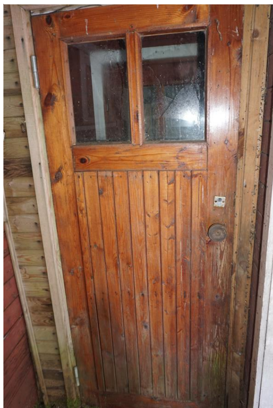
Joonis 3.70 Vaade kahjustunud välisuksele (Foto: autor, märts 2022)
