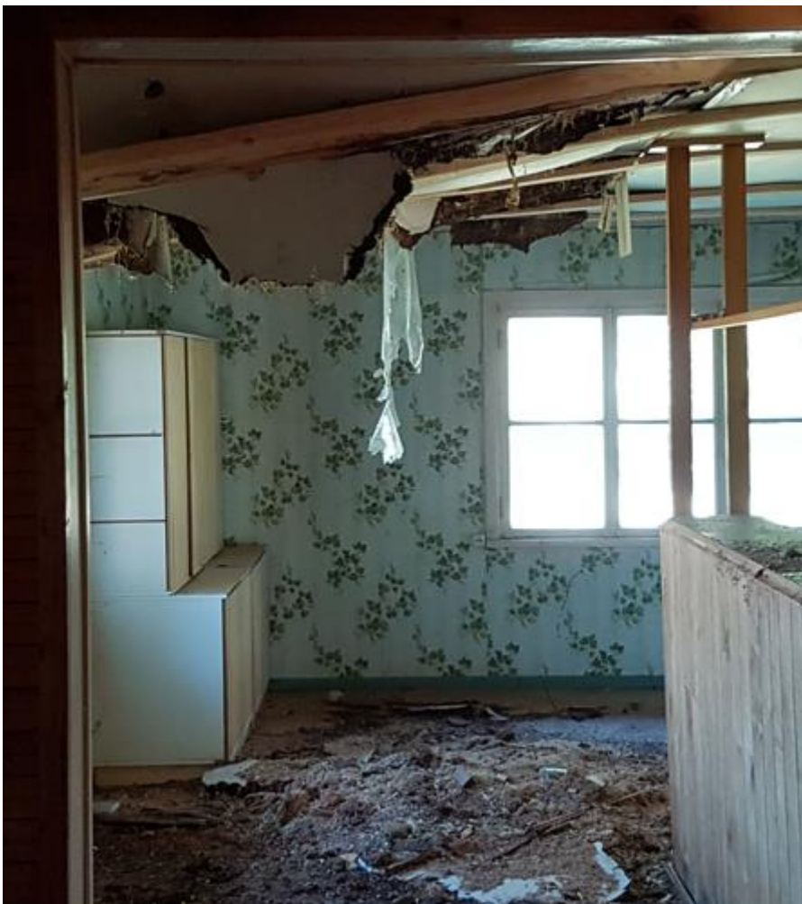
Joonis 3.14 Osaliselt sisse varisenud vahelagi köögis (Foto: autor, veebruar 2022)
