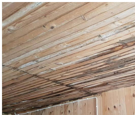
Joonis 3.63 Vaade niiskuskahjustustele (Foto: autor, märts 2022)
