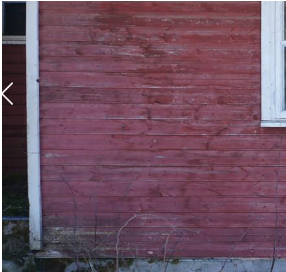
Joonis 3.6 Niiskuskahjustustega fassaadilaudis (Foto: autor, aprill 2022)
