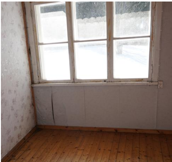
Joonis 3.46 Vaade niiskuskahjustustega toanurgale (Foto: autor, märts 2022)
