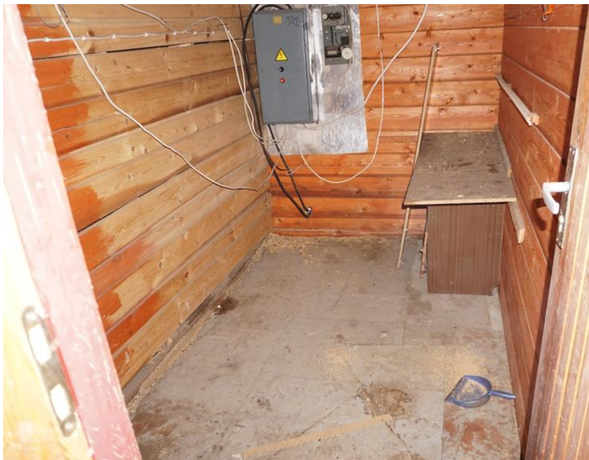
Joonis 3.50 Vaade tehnoruumi (Foto: autor, märts 2022)
