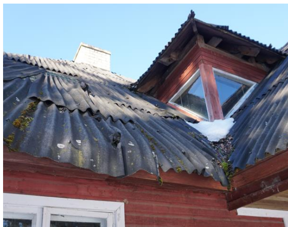
Joonis 3.75 Vaade kahjustunud katusekattele (Foto: autor, märts 2022)
