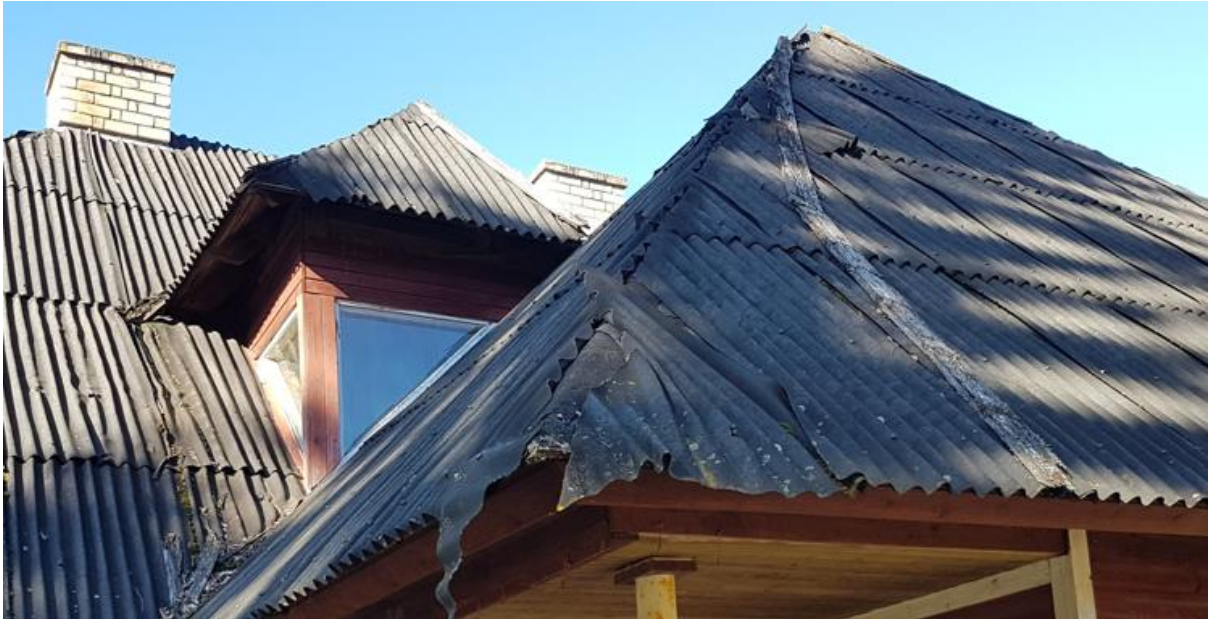
Joonis 3.9 Vaade ühele vintskapile ja ära vajunud puidust liistule katuse servas (Foto: autor, veebruar 2022)
