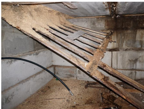
Joonis 3.28 Vaade kahjustunud laelaudisele (Foto: autor, märts 2022)
