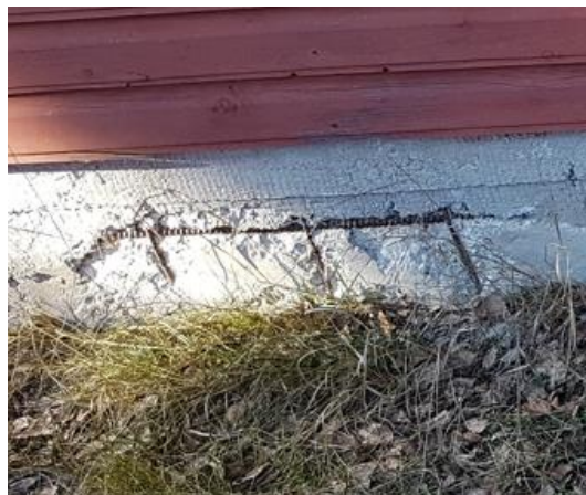
Joonis 3.4 Nähtav armatuur soklis (Foto: autor, aprill 2022)
