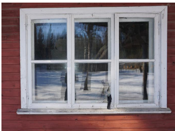
Joonis 3.18 Kahjustatud aknaklaas (Foto: autor, veebruar 2022)
