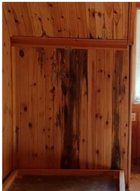
Joonis 3.58 Vaade niiskuskahjustustele (Foto: autor, märts 2022)
