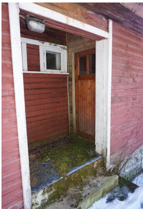
Joonis 3.69 Vaade kirdepoolsele sissepääsule ning kahjustunud välistrepile (Foto: autor, märts 2022)
