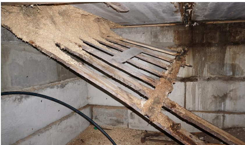
Joonis 3.12 Läbi mädanenud laekonstruktsioon ning välja pudenenud saepuru (Foto: autor, veebruar 2022)
