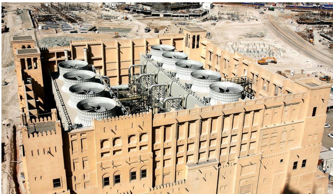
Joonis 1.1: Dubai kesklinna jahutusjaam [17]
