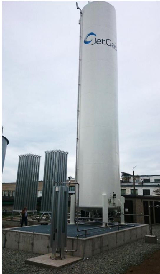
Joonis 1.3 – Saaremaa LNG gasifitseerimise jaam [23]
