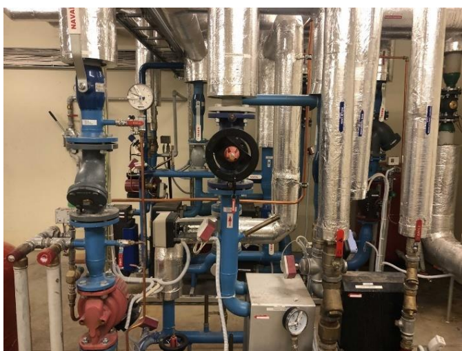
Joonis 4 SOC õppehoone soojussõlm, 05.04.2021
