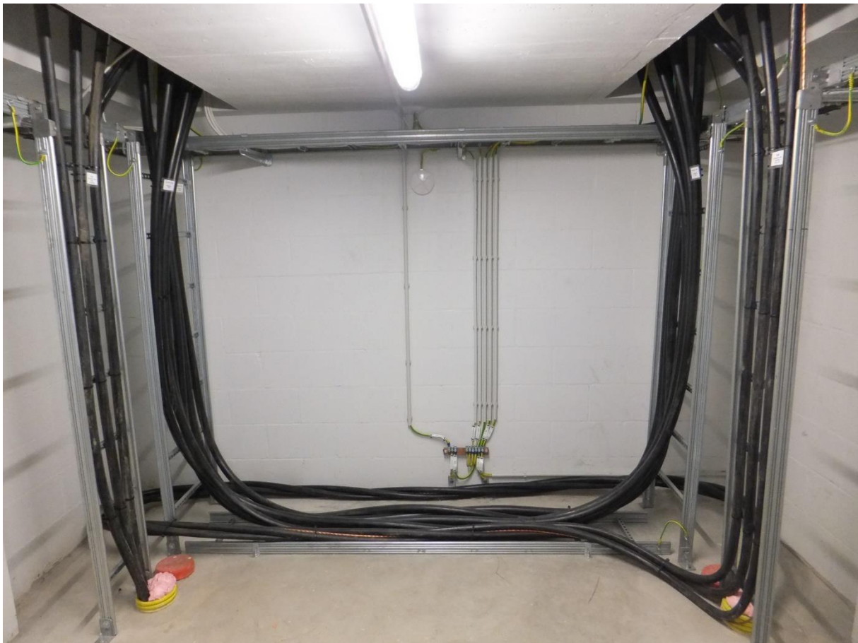
Joonis 8.11. Kõrgepinge kaabli sisenemiskoht kaablikeldris
