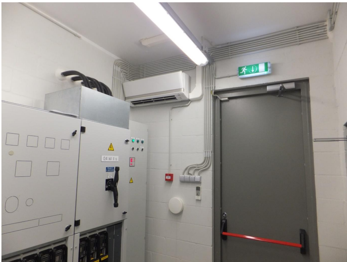
Joonis 7.16. Kaabli paigaldus PVC torudesse ja tuletõkketsoonide läbiviigude tihendamine (0,4kV II sektsiooni ja trafo T2 vaheline kaabel)
