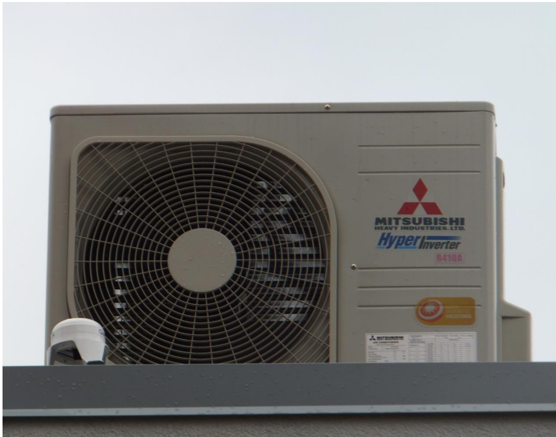
Joonis 7.17. Katusele paigaldatud soojuspumba välisosa
