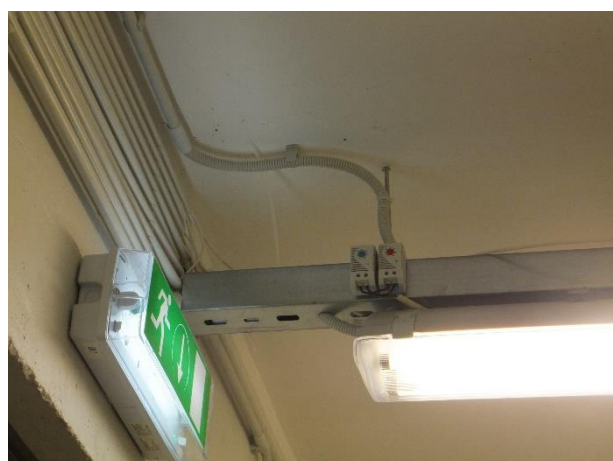
Joonis 8.7. 6 kV jaotusseadme ruumi hädavalgustus
