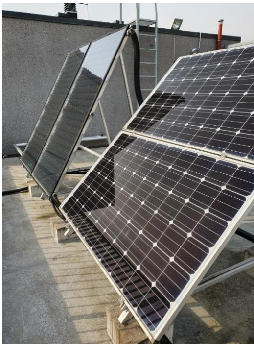
Joonis 3.2 Läti Tehnikaülikooli päikeseenergialabori lame-paneelkollektorid ja PV-paneelid [41]
