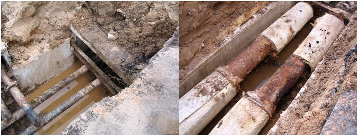
Sele 1.1. Võru vana maa-aluses kanalis paiknev soojustrass.
