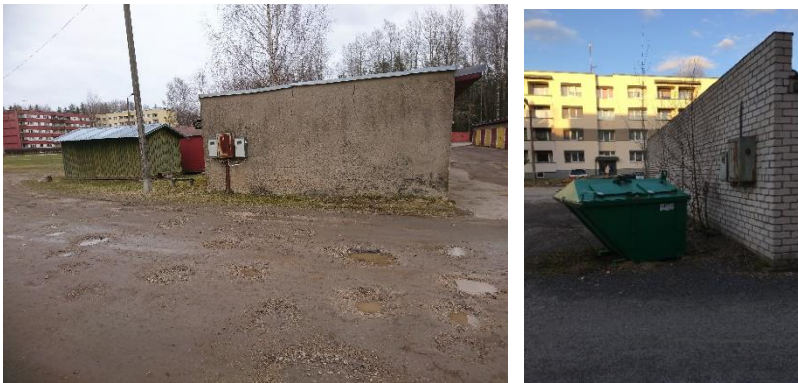
Fotod 4.13 ja 4.14 puudulikult tähistatud elektrikilbid avalikus ruumis
