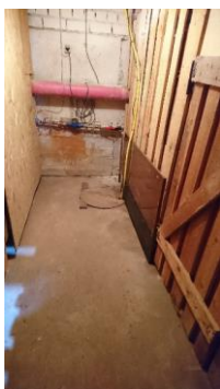
Foto 4.3 pump Valga 60 keldri pörandas sademevete välja pumpamiseks
