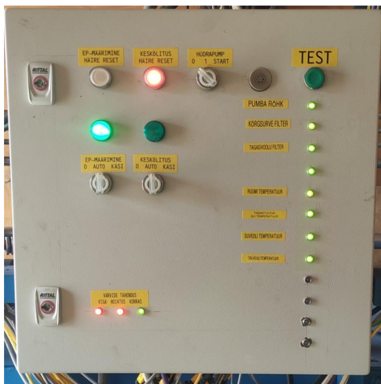
Joonis 4.12 Hüdrokeskuse elektrikiip väljast
