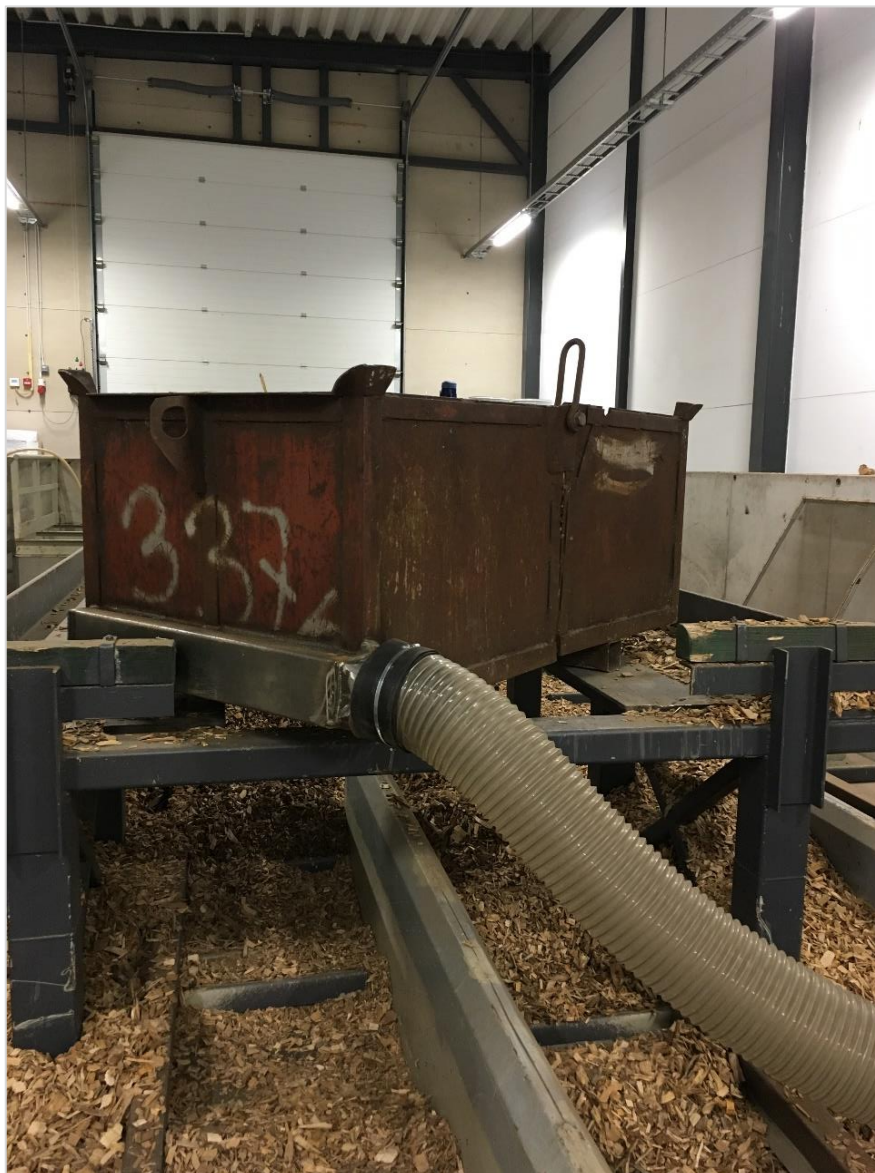
Joonis 4.10 Hakkepuidu kuivati. Pildi autor: Henry Rebane
