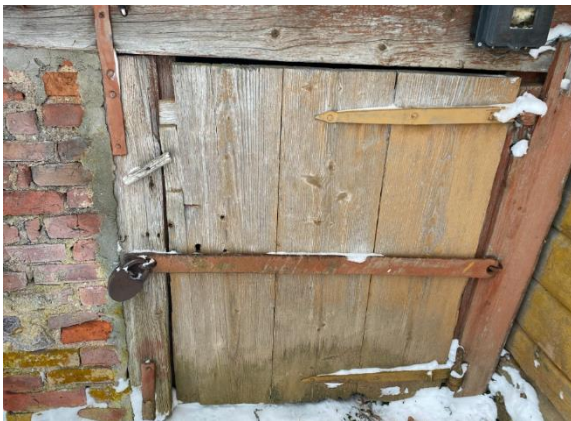
Joonis 3.9 Niiskuskahjustustega keldriuks (autori foto)
