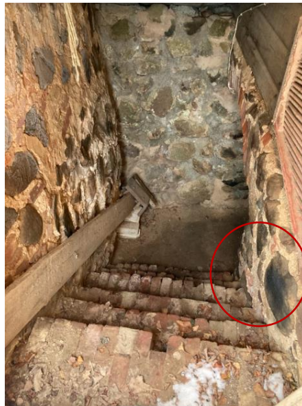
Joonis 3.2 Keldri sissepääsust on foto paremal osal näha vajunud vundamenti (autori foto)
