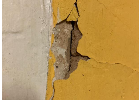
Joonis 3.21 Köögiseinal on pragunenud viimistluse alt näha konstruktsiooni (autori foto)
