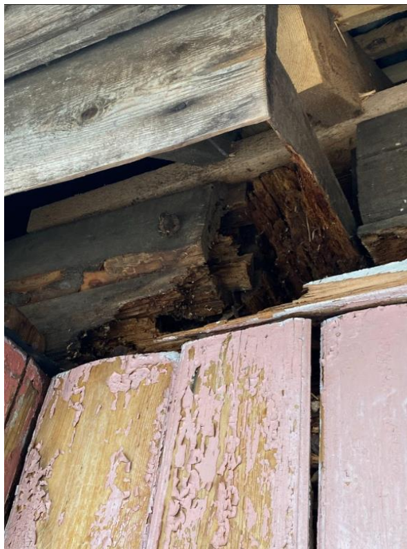
Joonis 3.28 Kahjustunud vahelaetala (autori foto)
