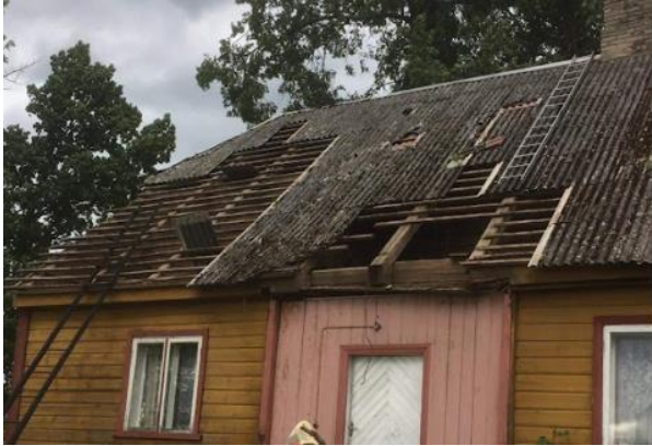
Joonis 3.31 Tormikahjustustega hoone (foto: erakogu)
