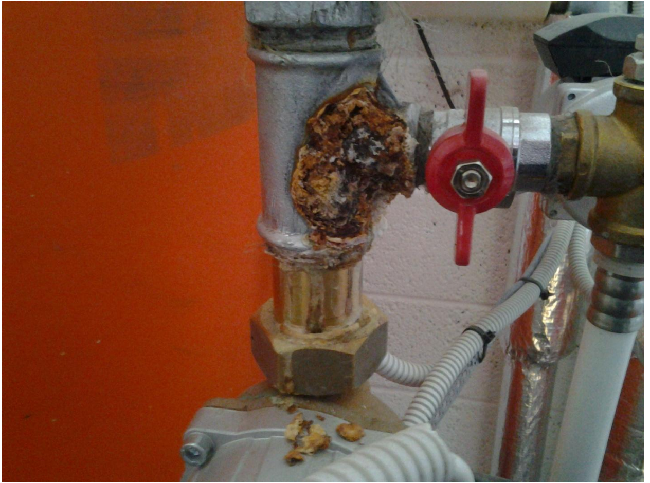
Pilt 3. Soojussõlmes korrodeerunud ühendus.
