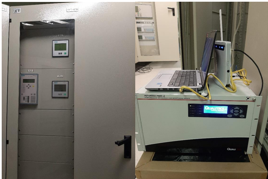
Joonis 2.4 Harku alajaamas Estlink 1 pingetrafo kamber (vasakul) ja mõõteahelasse ühendatud Qualitrol Informa PMD-A mõõteseade (paremal)
