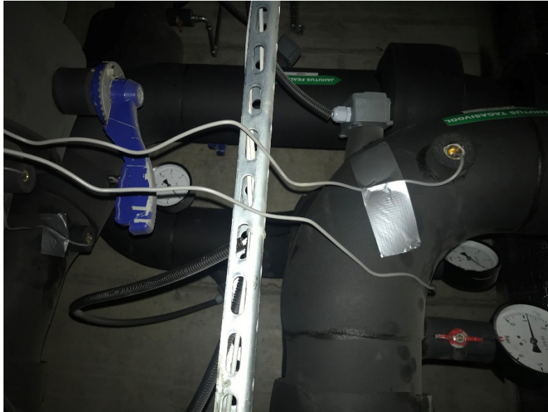
Joonis 1.5. Mõõdistuste teostamine KM1 vabajahutuse soojusvahetis
