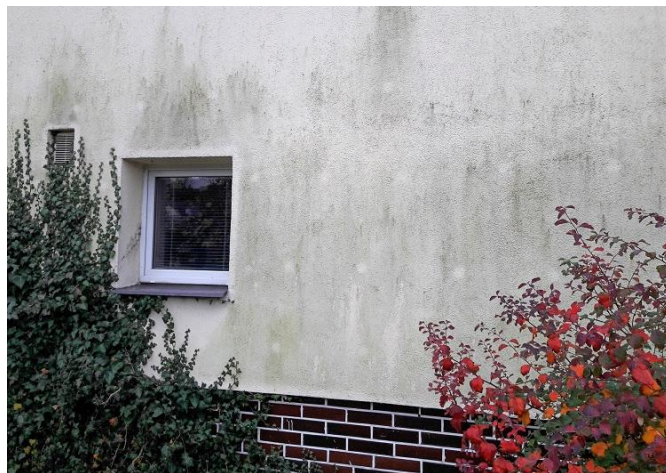
Joonis 1.9 Mikroorganismidega kahjustunud fassaadipinna värvierinevus [27], [38]
