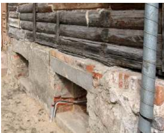
Foto 5. Keldri akna sillus ja puuduv voodrilaudis
