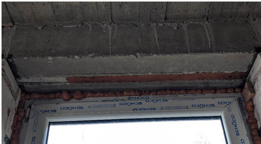
Joonis 3.17 Avatäite betoonsillus tekitab külmasilla (autori foto)
