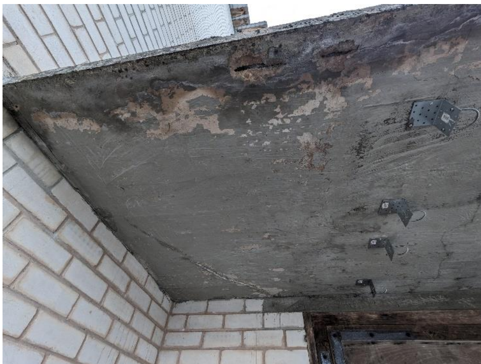
Joonis 3.15 Veekahjustustega raudbetoonist varikatus (autori foto)
