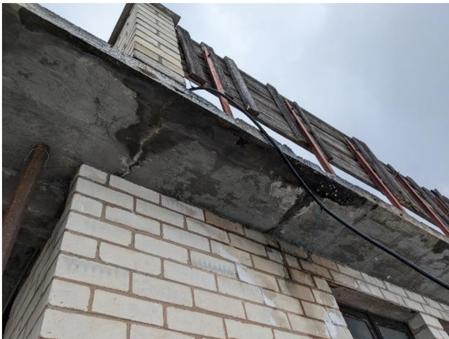
Joonis 3.6 Veekahjustusega fassaad (autori foto)
