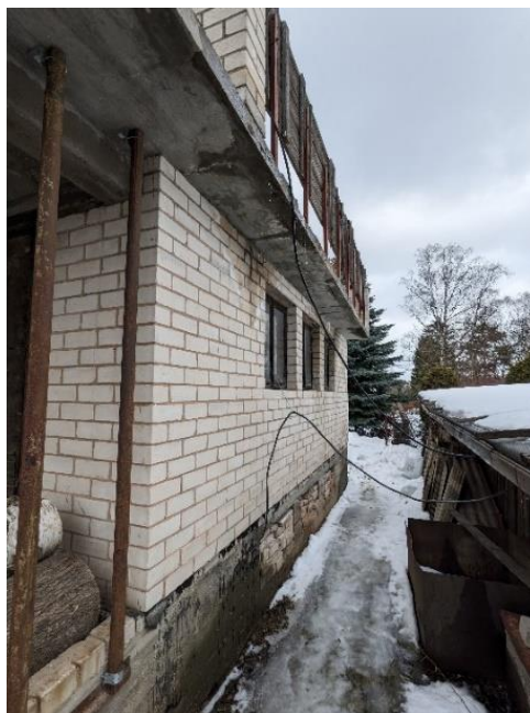
Joonis 3.3 Rõduplaadilt langev vesi on põhjustanud garaažiseina ja sokli veekahjustused (autori foto)
