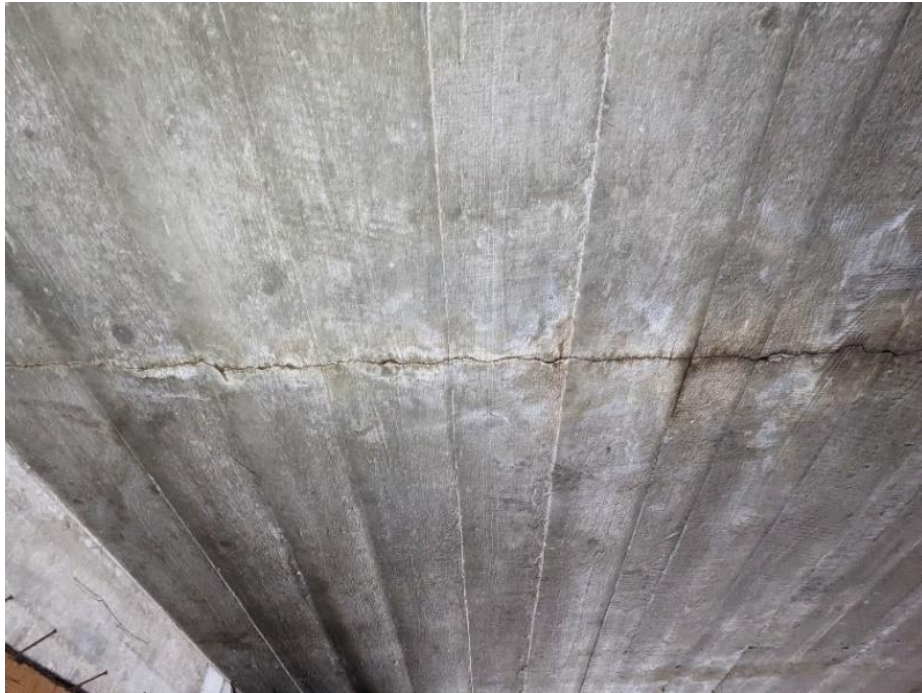
Joonis 3.9 Vee ligipääsusu tagajärjel konstruktsiooni on garaaži lae terastalad korrodeerunud ja tekkinud praod betooni (autori foto)
