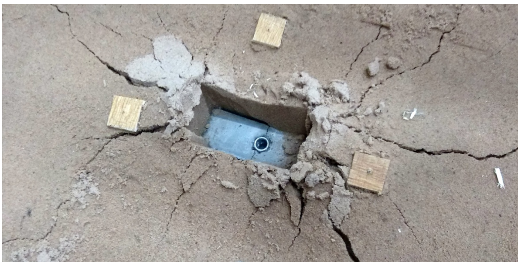
Joonis C.5. KV30/3 vaia süvistamisel tihedas pinnases toimunud pinnasedeformatsioon
