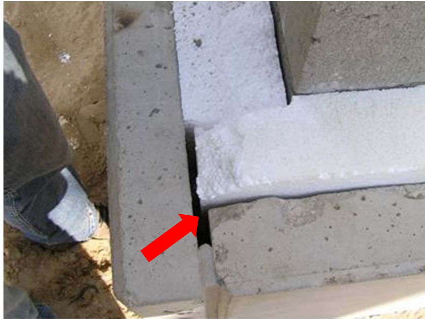
Joonis 1.3 Ebakorrektselt paigaldatud soojustus [5]
