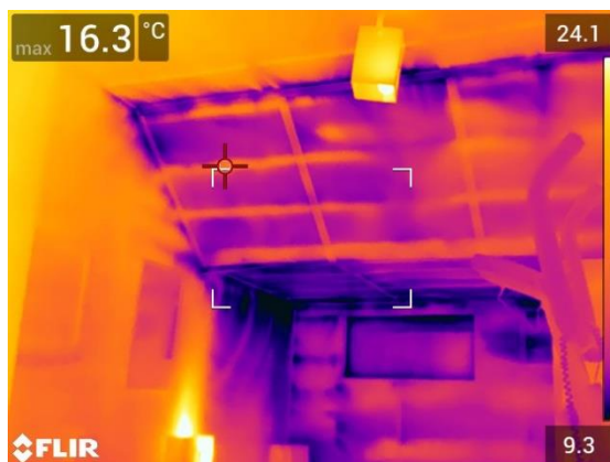
Joonis 2.1 Massiivne õhuleke katuse ja välisseina liitekohas
