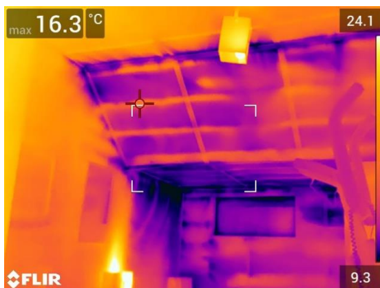
Joonis 2.1 Massiivne õhuleke katuse ja välisseina liitekohas
