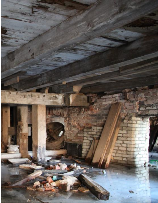
Pilt 13. Keldrisse tunginud pinnasevesi
