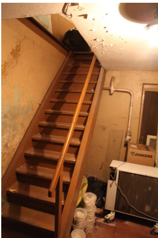
Pilt 6. Niiskuskahjustused soklikorrusel
