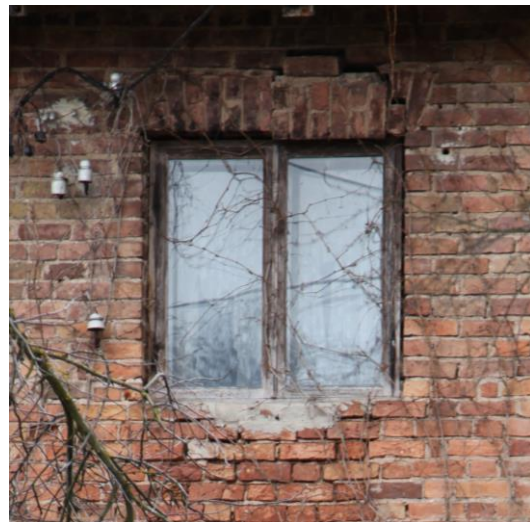
Pilt 23. Vajunud sillus. kahjustunud tellised
