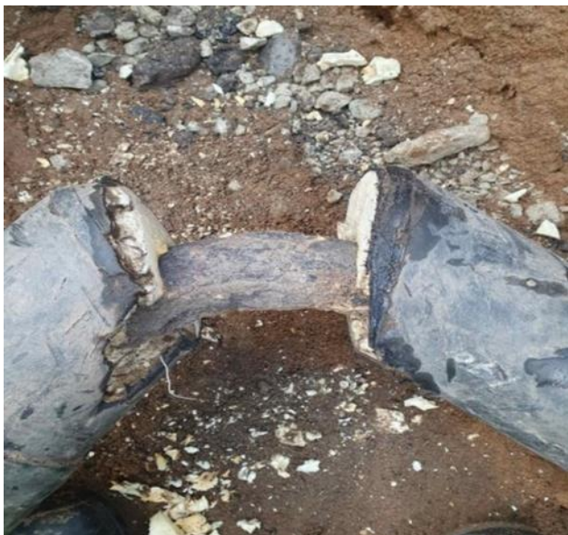
Joonis 3.3. Metall korrosioon isolatsiooni kahjustumisel.
