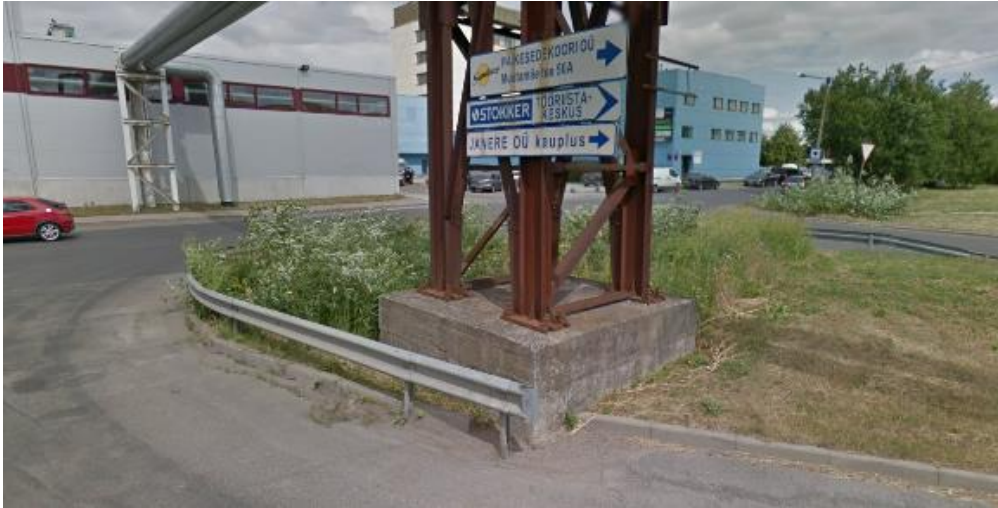
Joonis 1.7 Soojatorustiku kandemasti vundament Laki tn - Forelli tn ristmiku ohutussaarel (Google Maps Street View juuli 2019). [10]
