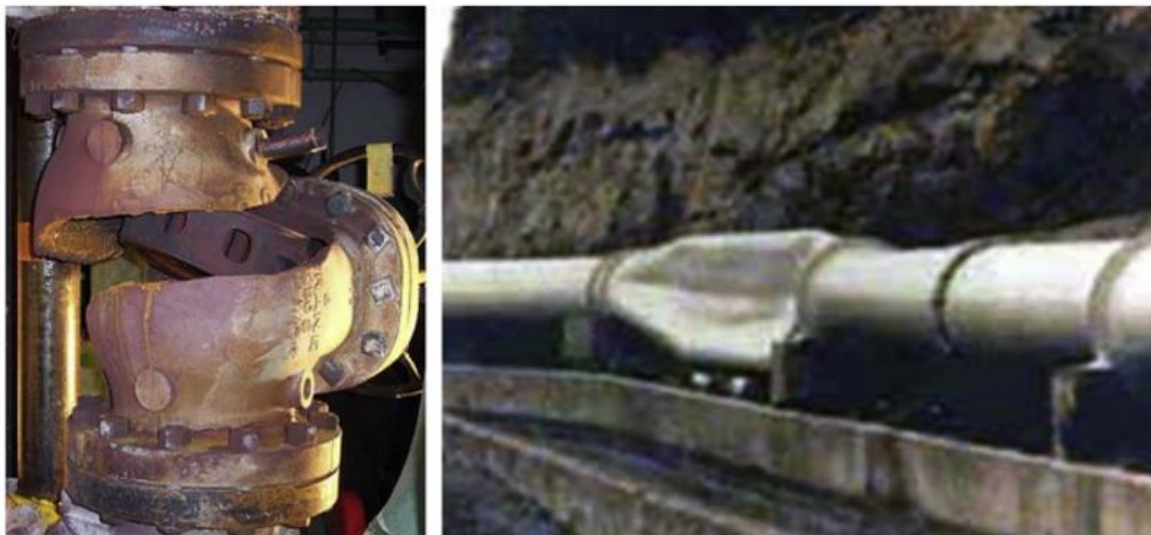
Joonis 4-2. Hüdraulilise löögi põhjustatud kahjustused. Vasakpoolsel pildil näidatud tagasilöögiklapi purunemine hüdraulilise löögi maksimaalse löögilaine tõttu. Parempoolsel pildil näidatud vaakumi tagajärjel sisse langenud torustik [18]
