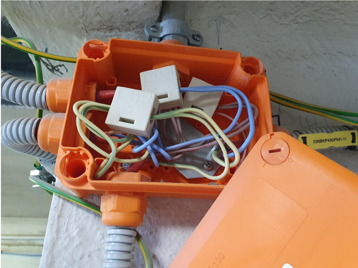
Joonis 1.5 Tulekindel jaotuskast.
