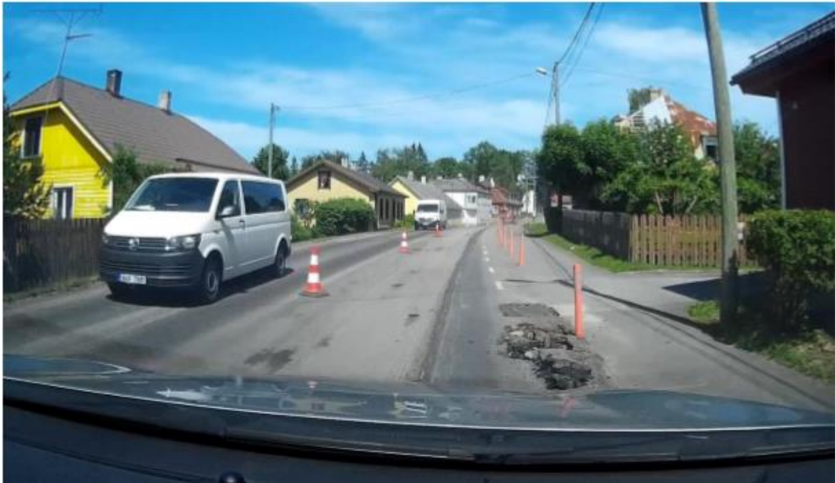
Joonis 2.15 Asfalditükid liiklusalas. Raske rikkumine. [7]
