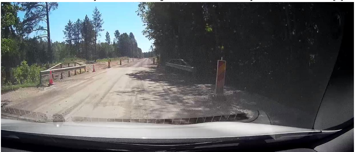
Joonis 2.17 Rammitavad piirded maha viimata/terminalid paigaldamata. Raske rikkumine. [7]
