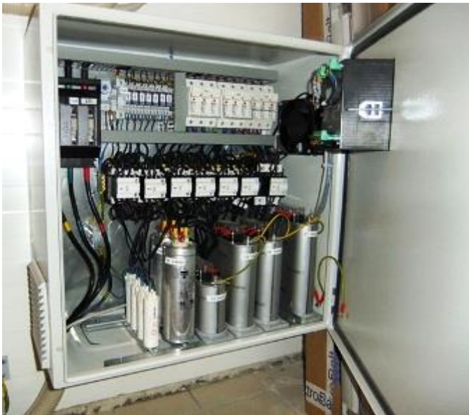
Joonis 37. Reaktiivvõimsuse automaatne kompensatsiooniseade. [19]
