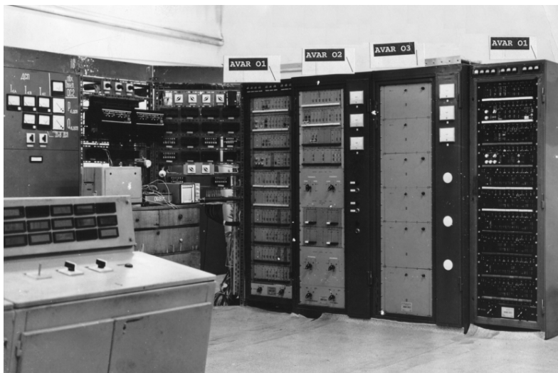
Tehase „AMURSTAL” dünaamilise reaktiivvõimsuse kompensaatori (35 kV, 160 Mvar reaktor ja 132 Mvar mahtuvusvõimsus) reaalaja juht-, kaitse- ja diagnostikasüsteem. Esimene süsteem paigaldati Moldova Metallurgiatehase sama võimsusega kompensaatorile.
