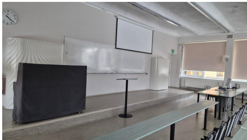
Joonis 6. U05-103, tagaseinas väljatõmberestid ja uksepoolse seina vastas sissepuhke õhujaotajad. Alumisel fotol seina ääres valged sissepuhke õhujaotajad, analoogsed ruumides U03-103 ja U04-103 sama paigutusega.
