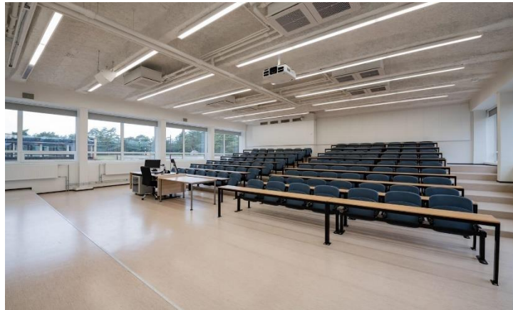
Joonis 4. Auditorium U04-103, tagaseinas väljatõmberestid ja uksepoolse seina vastas sissepuhke õhujaotajad [21]
