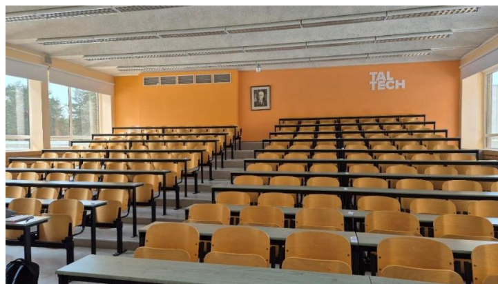
Joonis 5. Auditorium U04-103, tagaseinas väljatõmberestid ja uksepoolse seina vastas sissepuhke õhujaotajad
