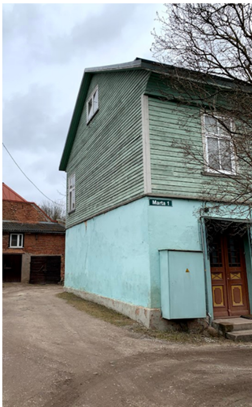
Joonis 4.2 Hoone otsaseina seisukord teljel 1 (autori foto nr. 003)
