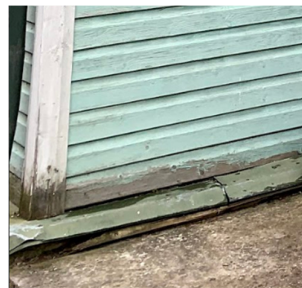
Joonis 4.10 Teljel 3 asuva trepikoja sokkel ja välisseina niiskuskahjustus. (autori foto nr. 007)
