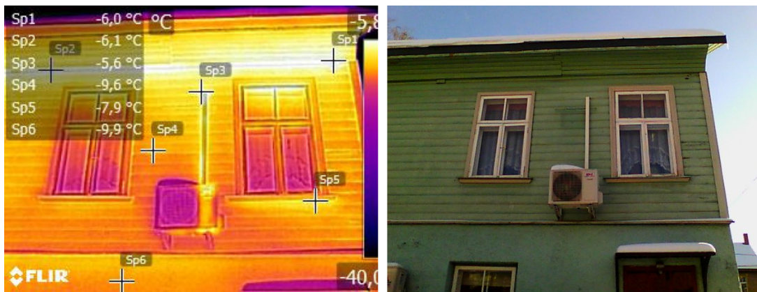
Joonis 4.17 Külmasild õhksoojuspumba torustiku läbiviigul ning räästas. Termokaamera pilt nr.07
