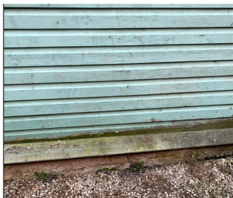
Joonis 4.9 Teljel 3 asuva trepikoja sokkel ja välisseina niiskuskahjustus. (autori foto nr. 008)
