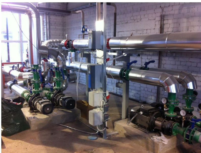
Sele 2.11.1 Katla ja soojusvõrgu tsirkulatsiooni pumbad
