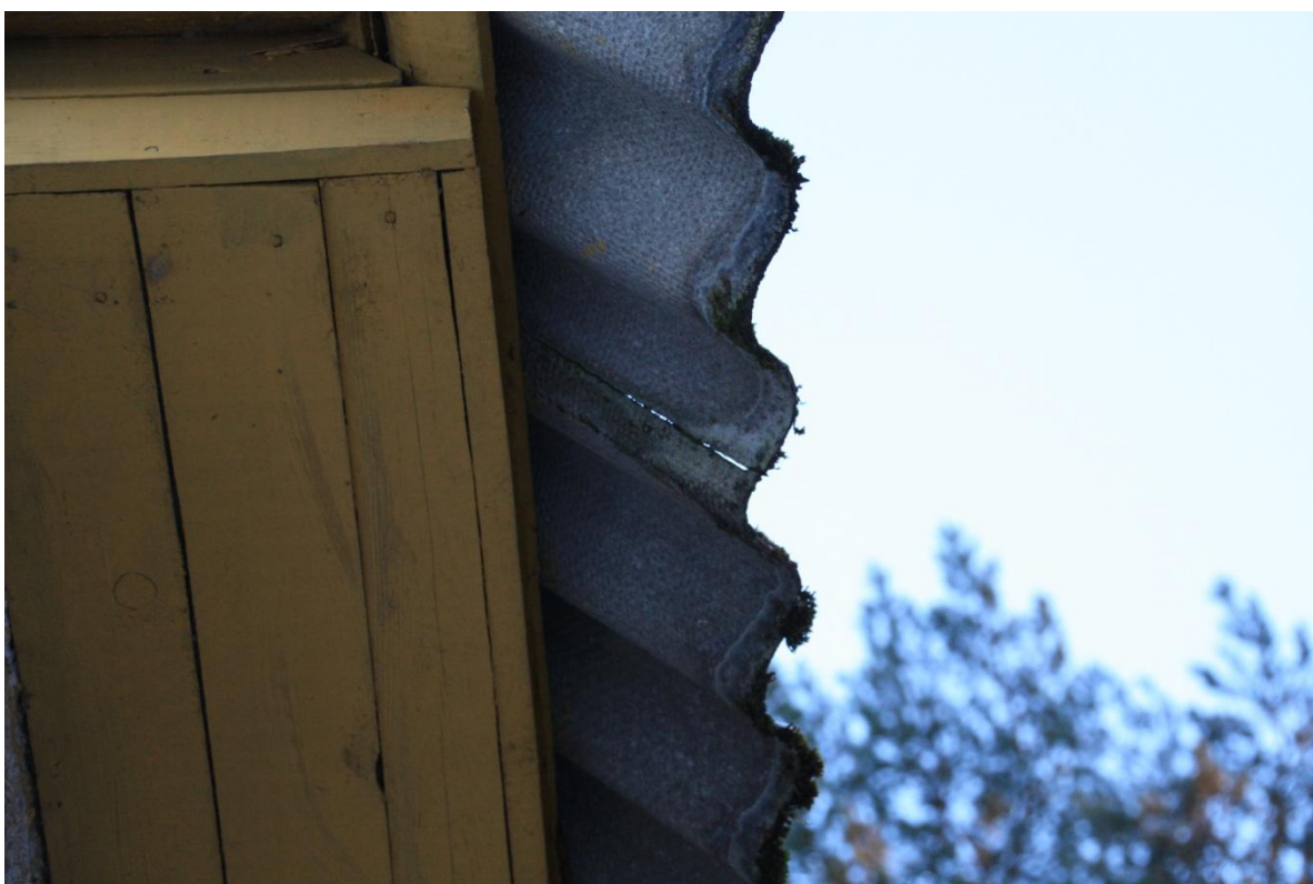
Foto L1. 11. Kohati mõranenud eterniit
