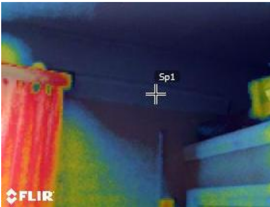
Termofoto L4.7. Ära vajunud soojustus endise teenindusruumi põhjanurgas
