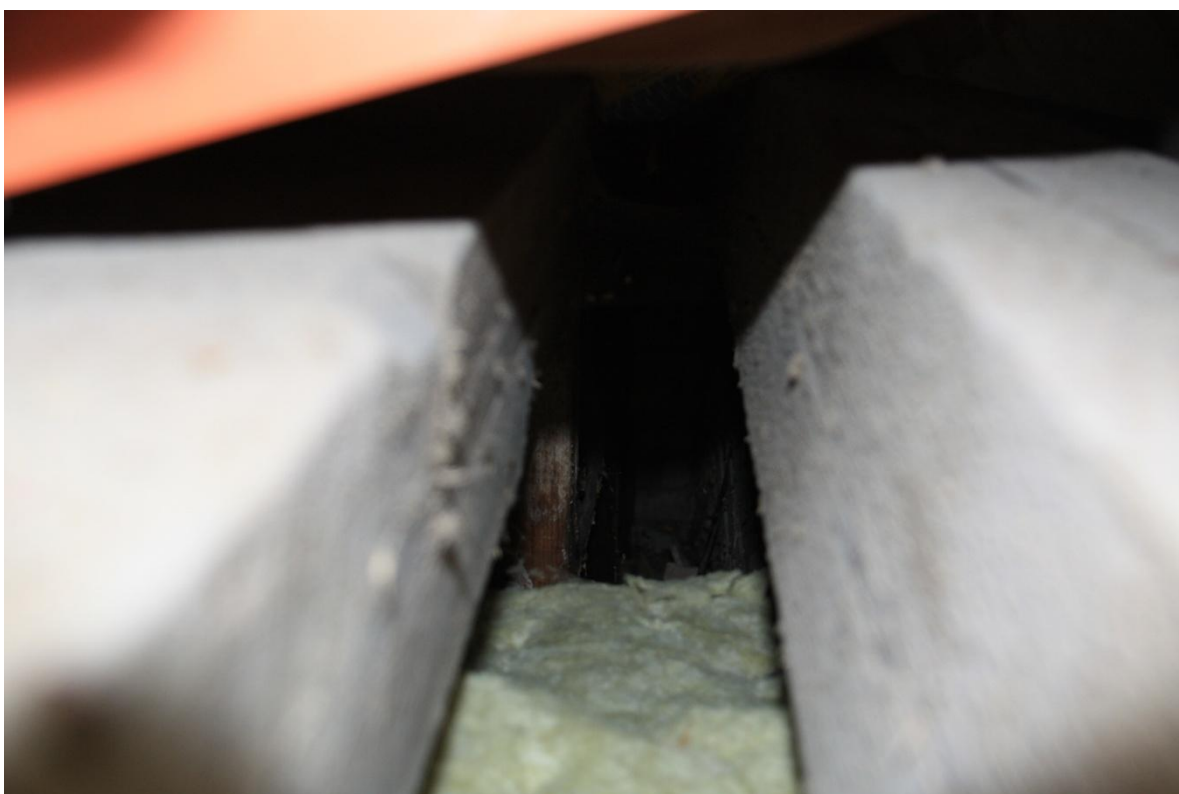
Foto L1. 6. Ära vajunud soojustus loodenurga I korruse seinas
