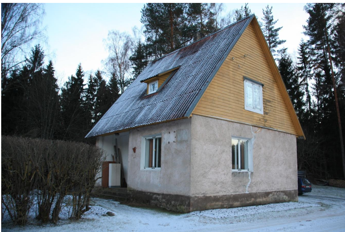
Foto L1. 9. Määrdunud krohv I korruse loodekülje akna ees
