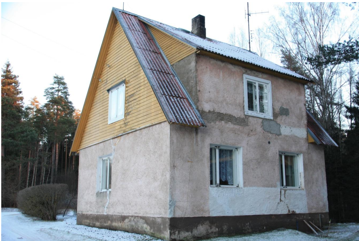
Foto L1. 8. Värvikahjustused fassaadil, katuseviilul ja katusel
