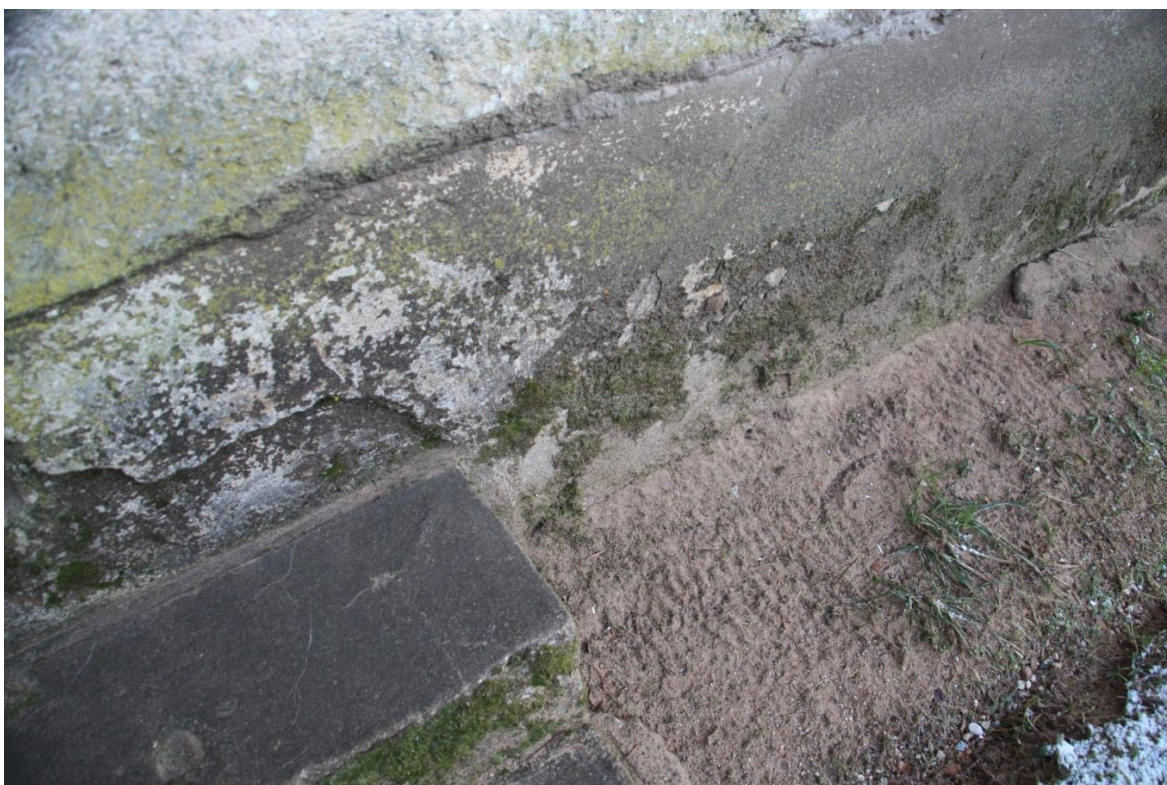
Foto L1. 1. Peened mõrad vundamendis, sammaldumine
