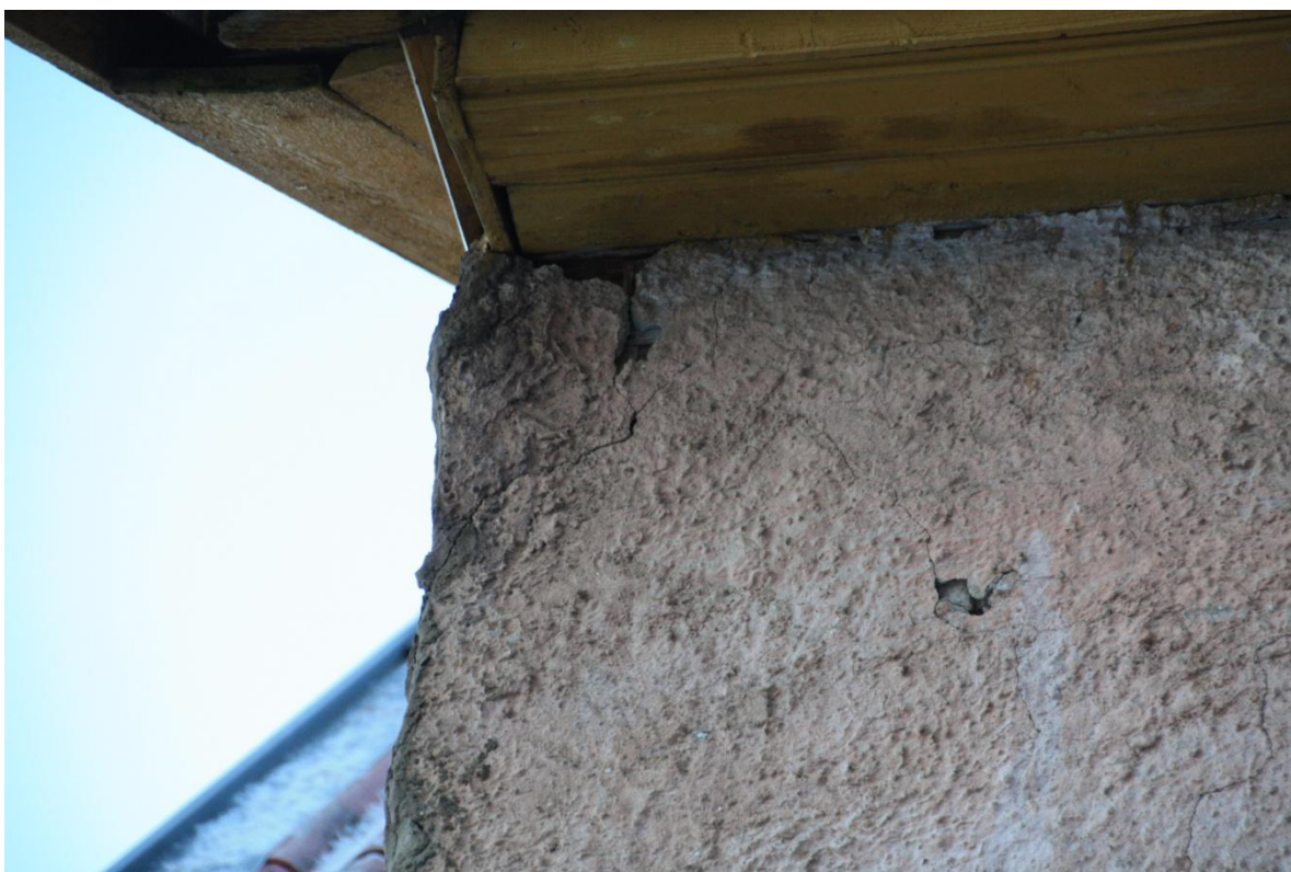
Foto L1. 5. Krohvikahjustused II korruse edelenurgas
