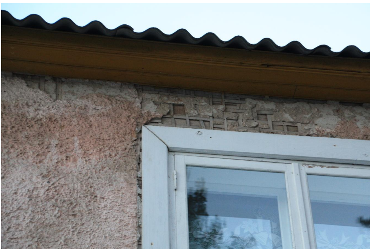
Foto L1. 4. Krohvikahjustused II korruse edelakülje seinal
