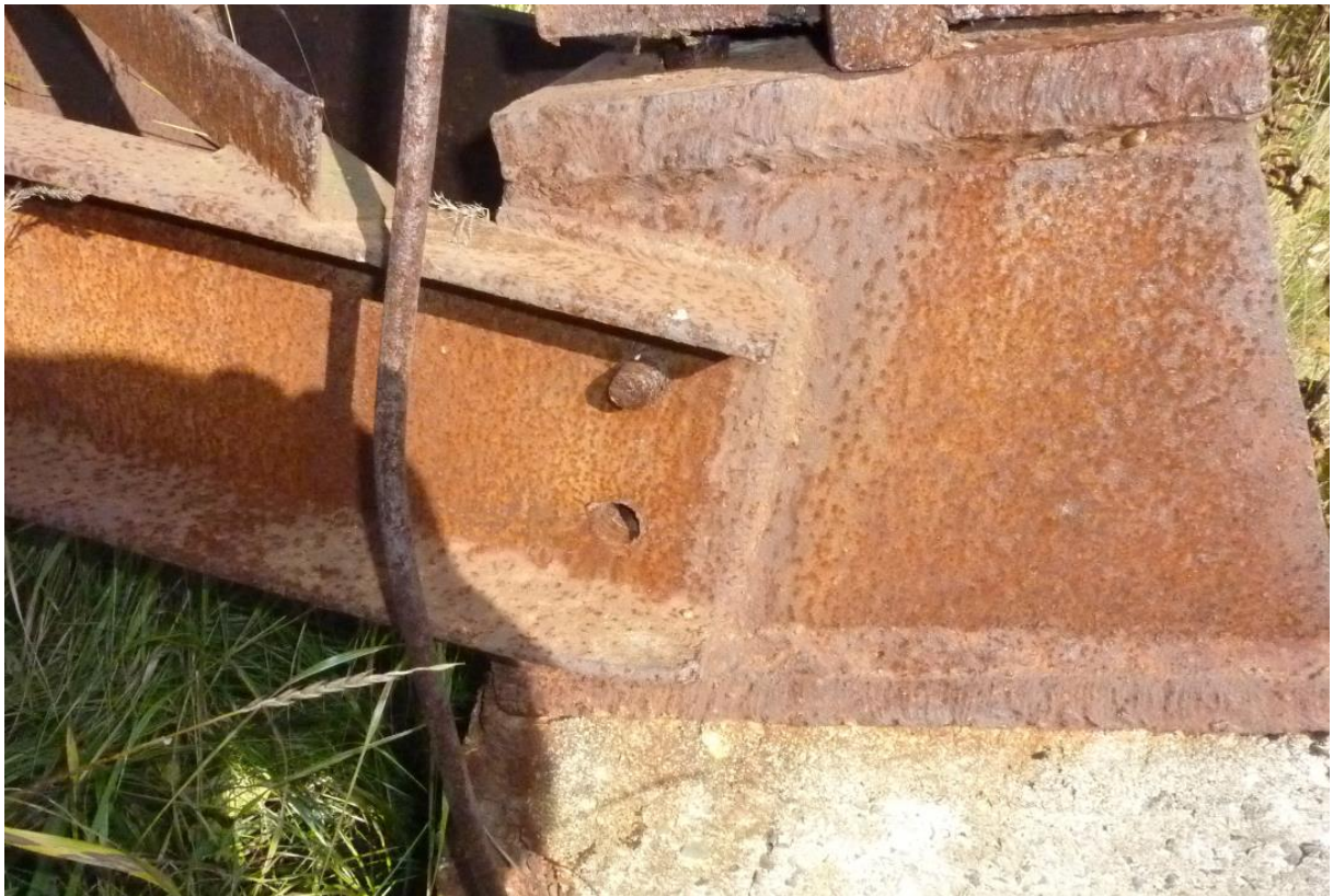
Joonis L.5. Väga tugevalt korrodeerunud teras (hinnang 5) [11]
