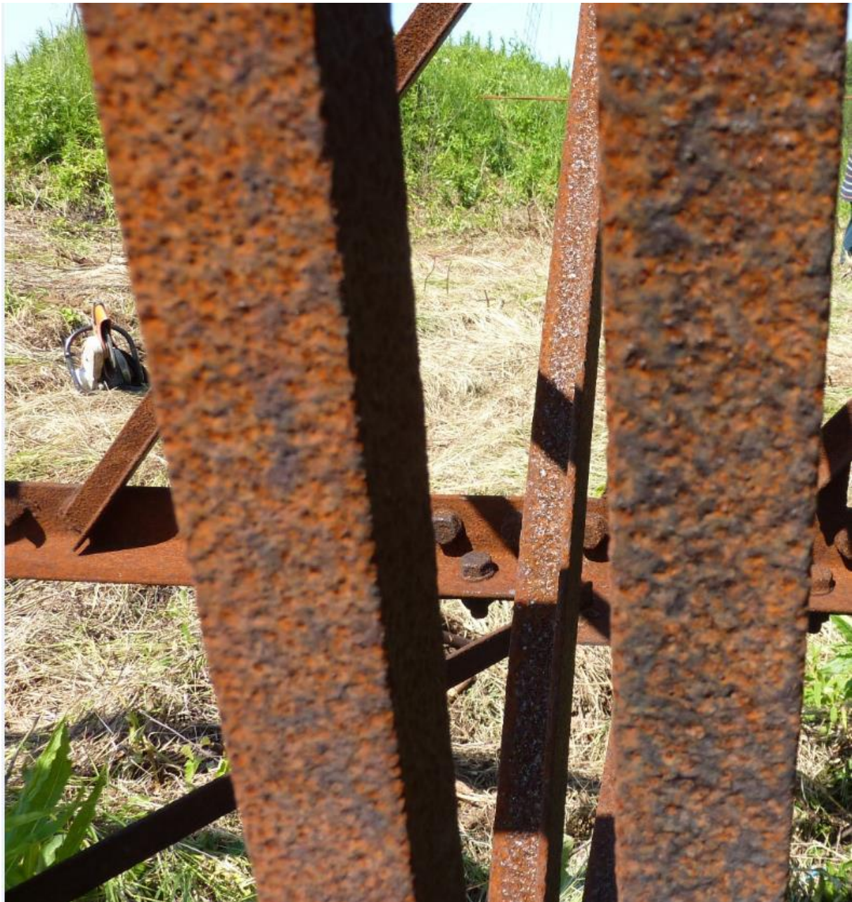
Joonis L.6. Tugevalt korrodeerunud teras (hinnang 4) [11]
