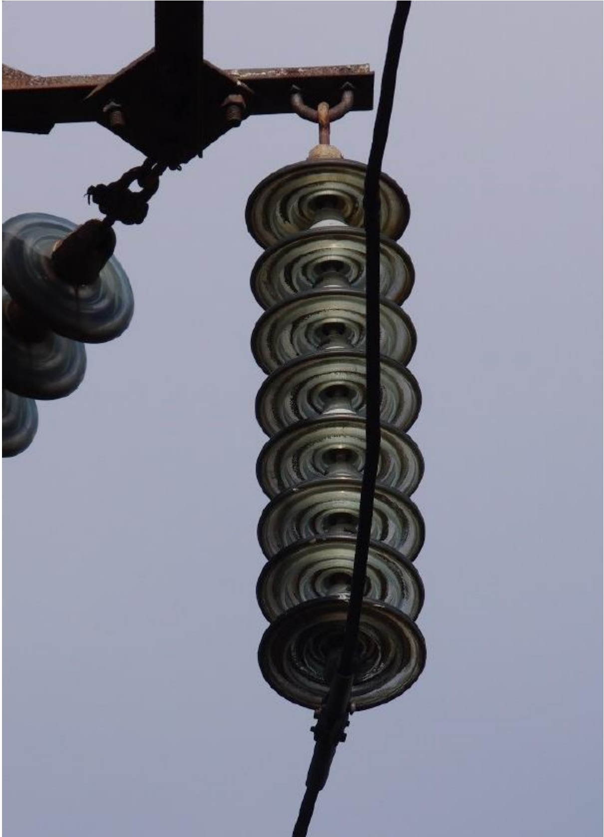
Joonis L.10. Väga saastunud klaasisolaatorkett [44]
