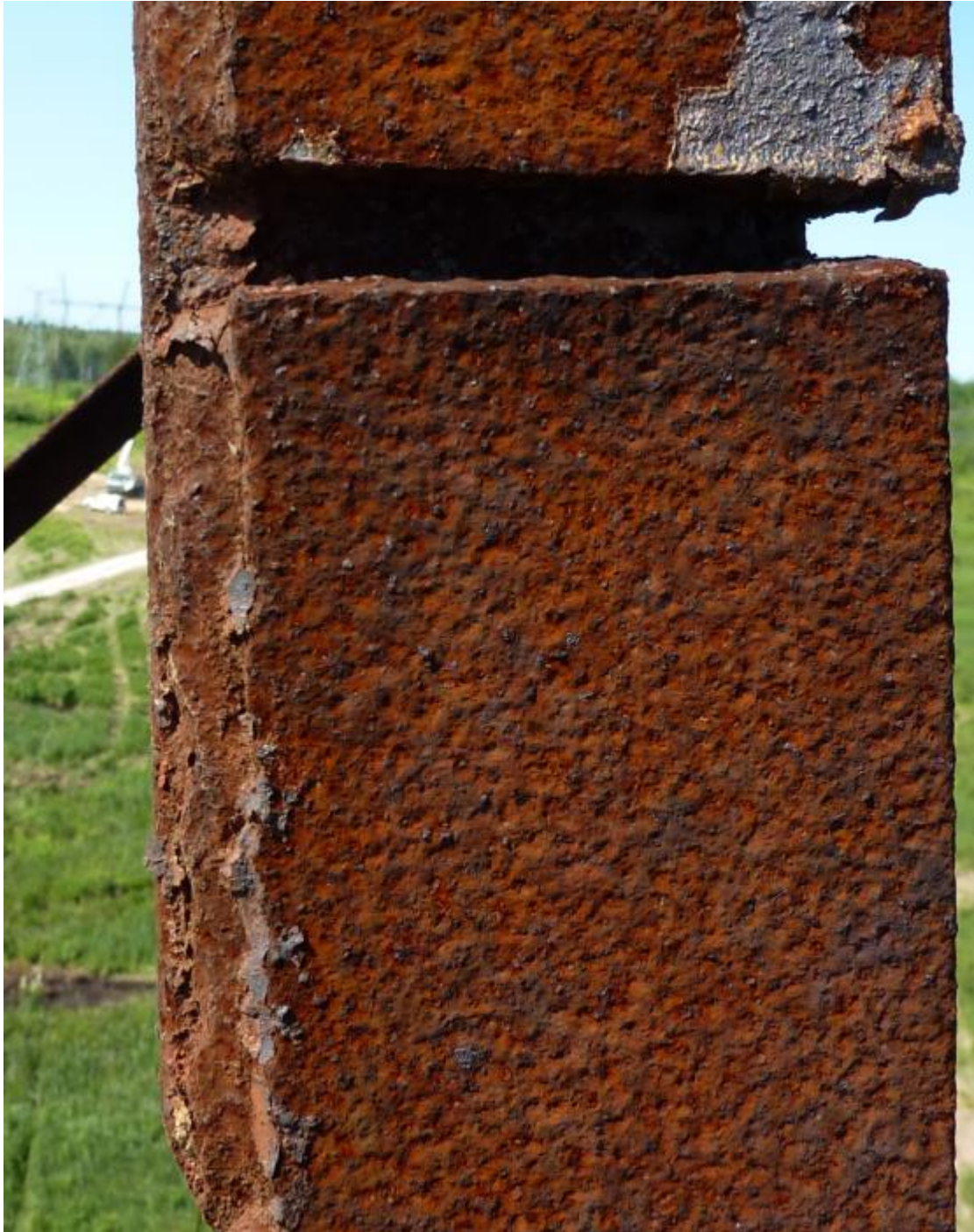
Joonis L.7. Korrodeerunud teras (hinnang 3) [11]
