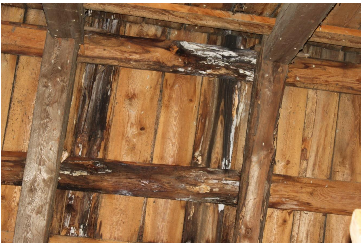
Foto 6. Sadevee läbijooks on roovil ja püstlaudisel niiskuskahjustused põhjustanud. Detsember 2020. Autor: Elo Sinisaar
