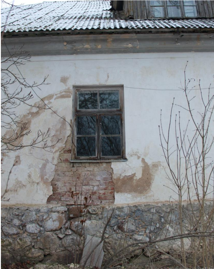
Foto 3.5. Krohvikahjustus lõunafassadil. Valestipaigaldatud antenn juhhib sadevee otse katusele fassaadile. November 2020. Autor: Elo Sinisaar
