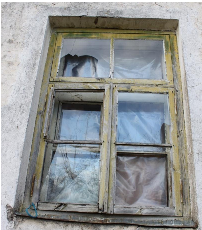
Foto 3.10. Lõhutud aknaklaasidega originaalne puitaken A8. Aprill 2021. Autor: Elo Sinisaar
