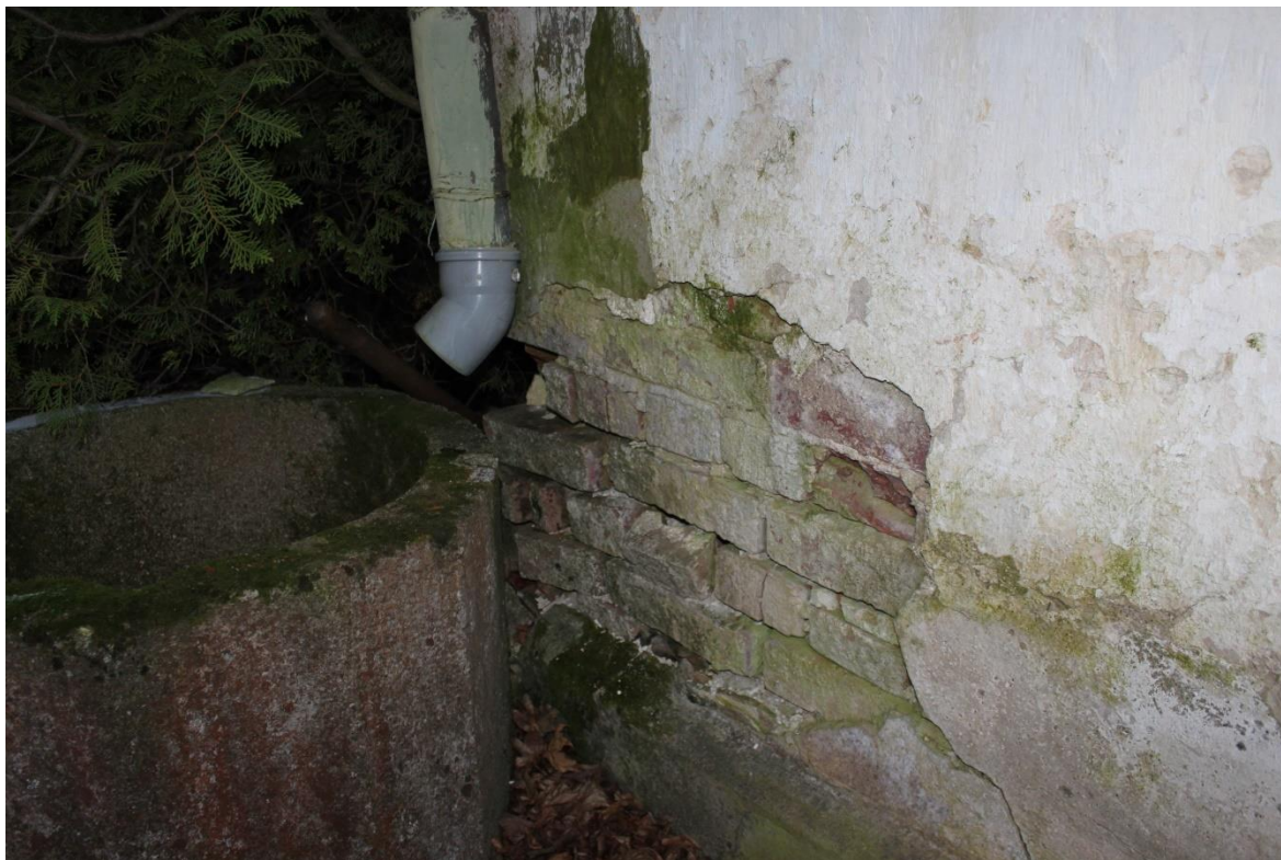
Foto 3. Hoone lagunened kirdenurk. Vihmaveetoru puudulik lahendus on põhjustanud müüritise lagunemise. November 2020. Autor: Elo Sinisaar
