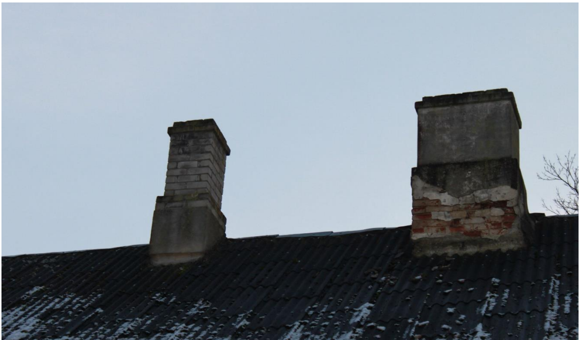
Foto 3.6. Korrastamist vajavad korstnad. November 2020. Autor: Elo Sinisaar
