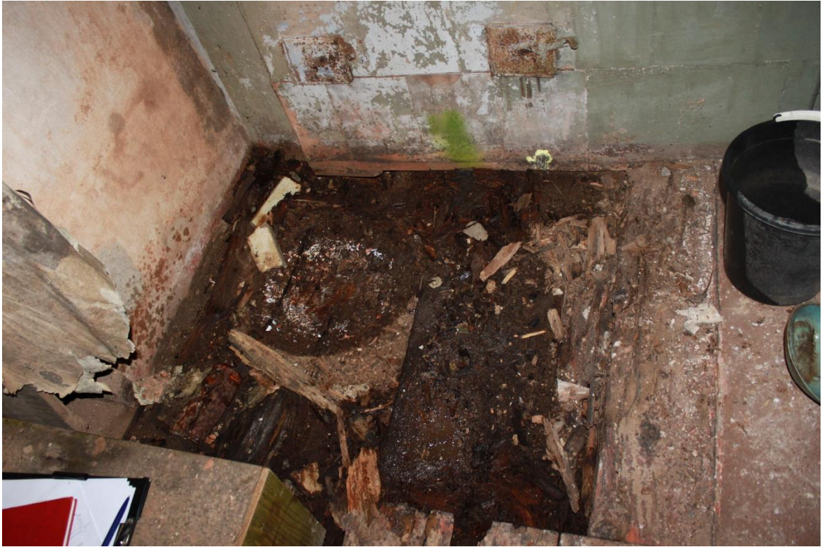
Foto 3.25. Märgunud põrand, mis on tingitud katuse läbijooksust. November 2020. Autor: Elo Sinisaar
