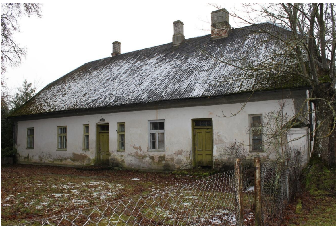
Foto 2. Niiskuskahjustustega põhjapoolne fassaad. November 2020. Autor: Elo Sinisaar
