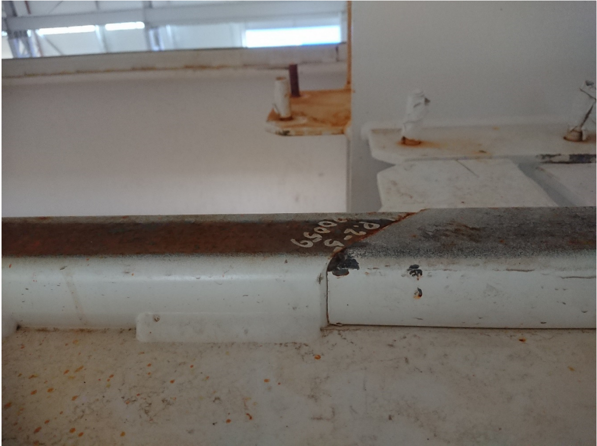
Joonis 5.8 Kahe kraanarelsi liitekoht, mis vajab reguleerimist
