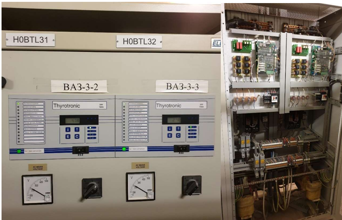
Joonis 1.2 BA3 3-3-2 ja BA3 3-3-3 esipaneel ja elektrikapi sisevaade
