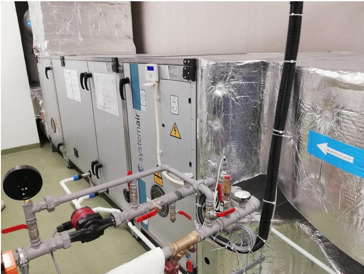
Joonis 2.4 Tsentraalne ventilatsioonisüsteem DVCompact 20. (Autor, 2019)
