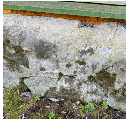
Joonis 2.12 Kahjustunud sokkel (autori foto, aprill 2020)
