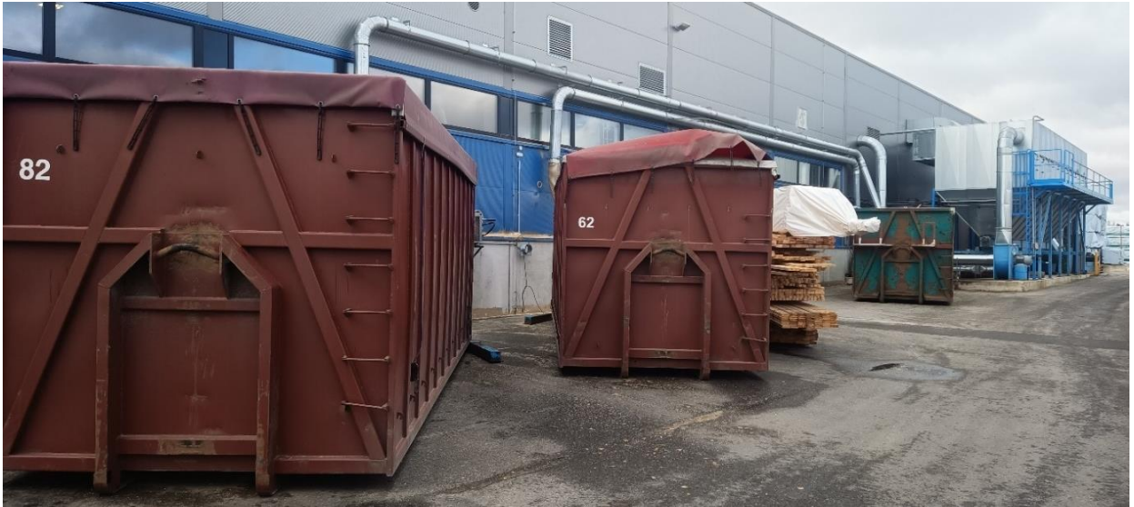
Joonis 17. Uue tehase aspiratsioonisüsteem
